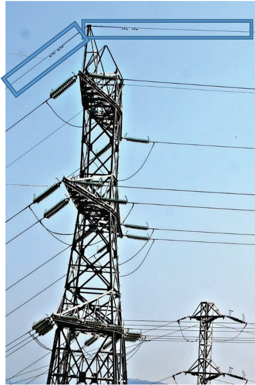
Imagen 5. Cable de tierra o fibra óptica. [10]
