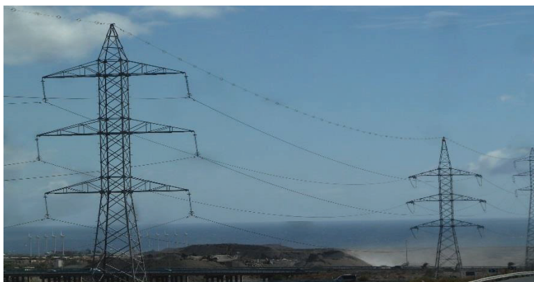
Imagen 3. Líneas Eléctricas Aéreas de Alta Tension. [9]
