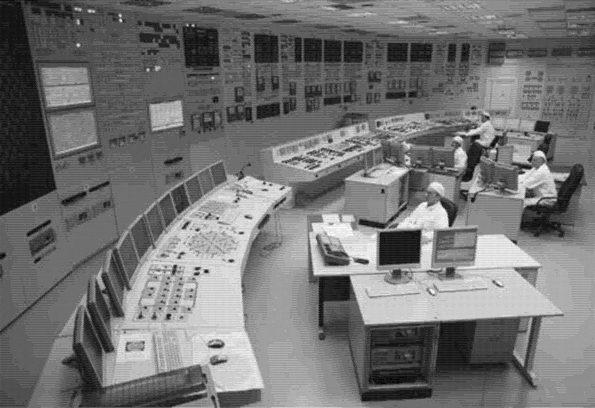
Sala de control actual de uno de los reactores de la central nuclear de Leningrado, muy parecida a Chernóbyl.
