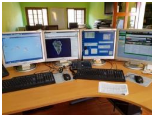
Figura 8: Puesto 1 de la Sala de Control
