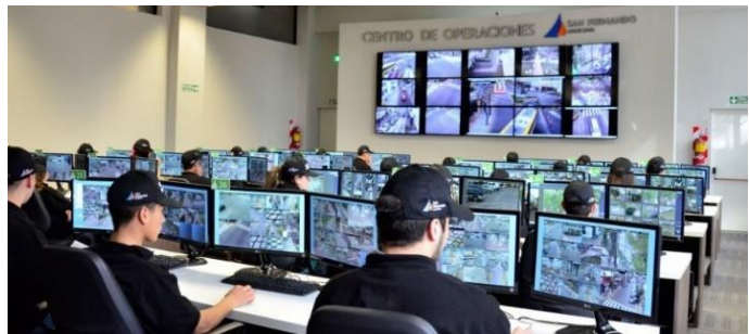
Ilustración 27 Centro de Operaciones (COSF) de San Fernando Argentina.
