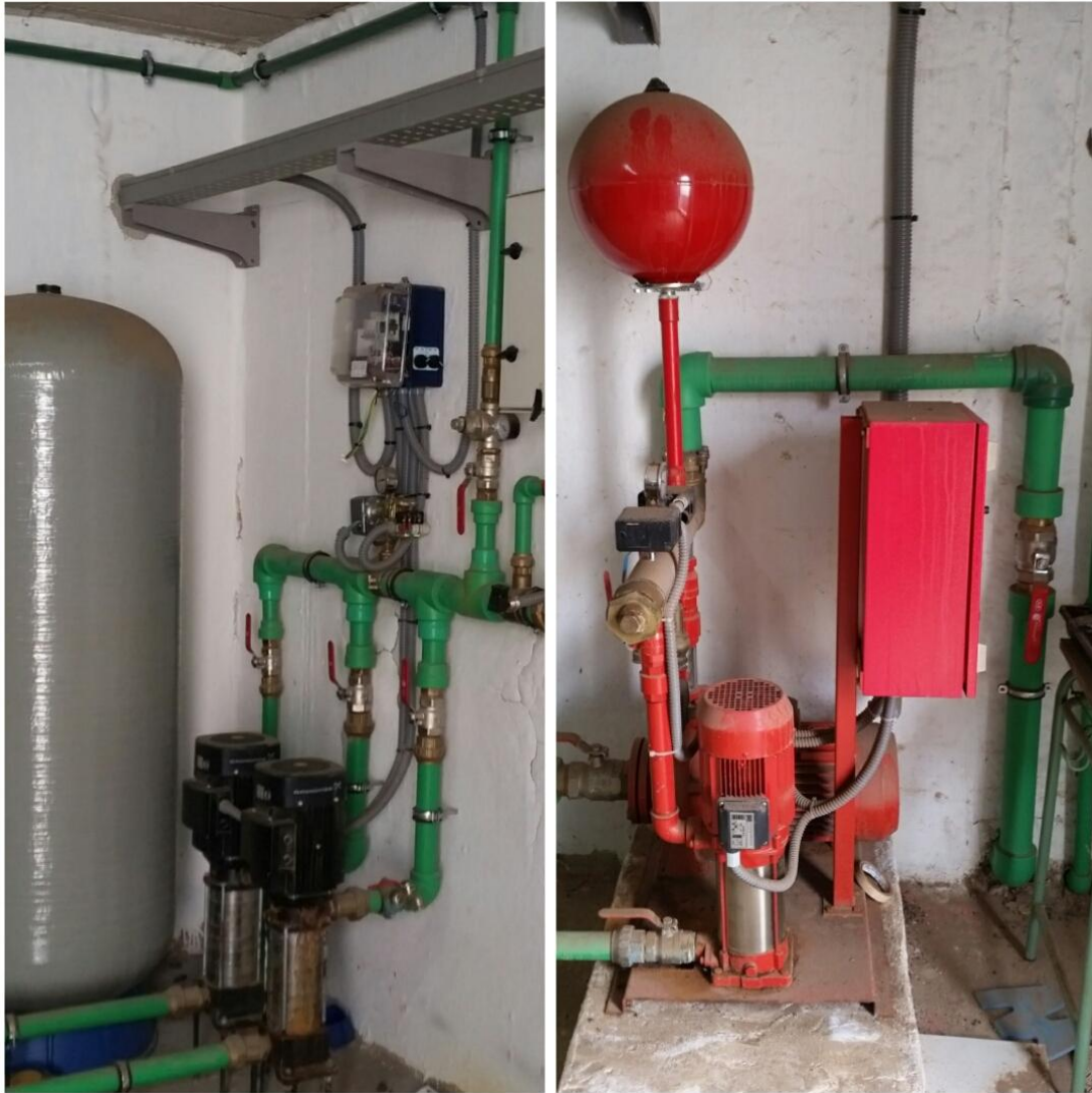
Imagen nº 26. Bombas principales y bomba jockey contra incendios. Fuente: Iván Tejera.
