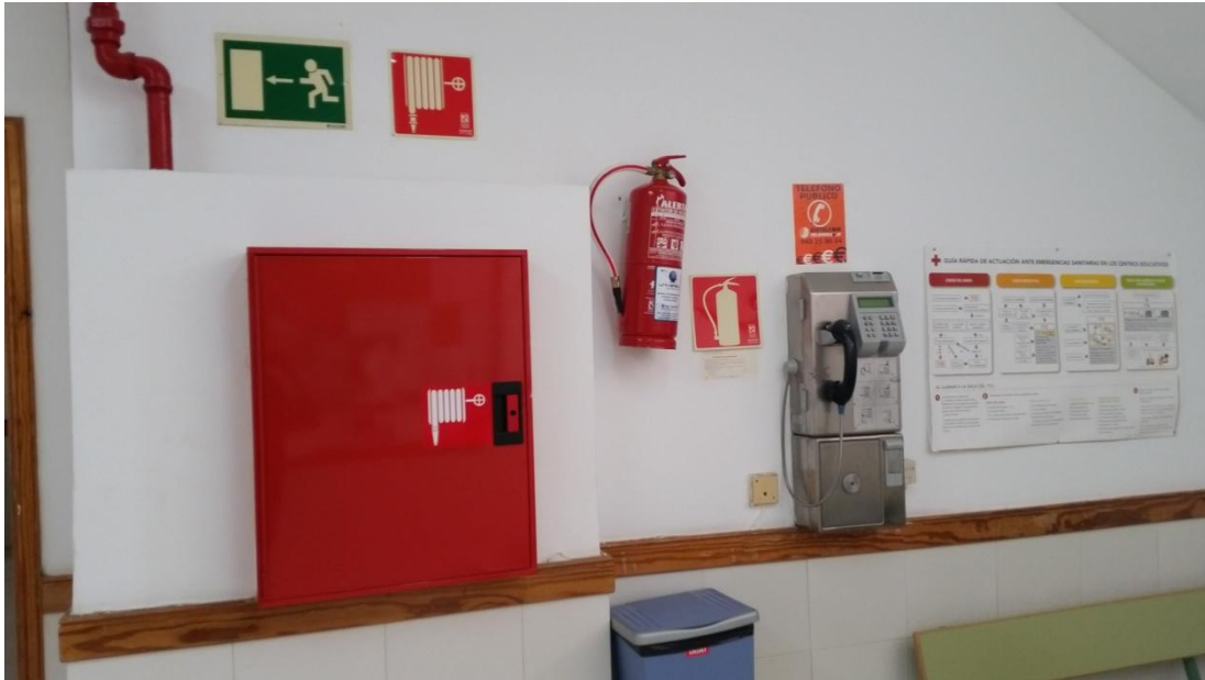
Imagen nº 27. Señalización; extintor y BIE en el I.E.S Cesar Manrique. Fuente: Iván Tejera.
