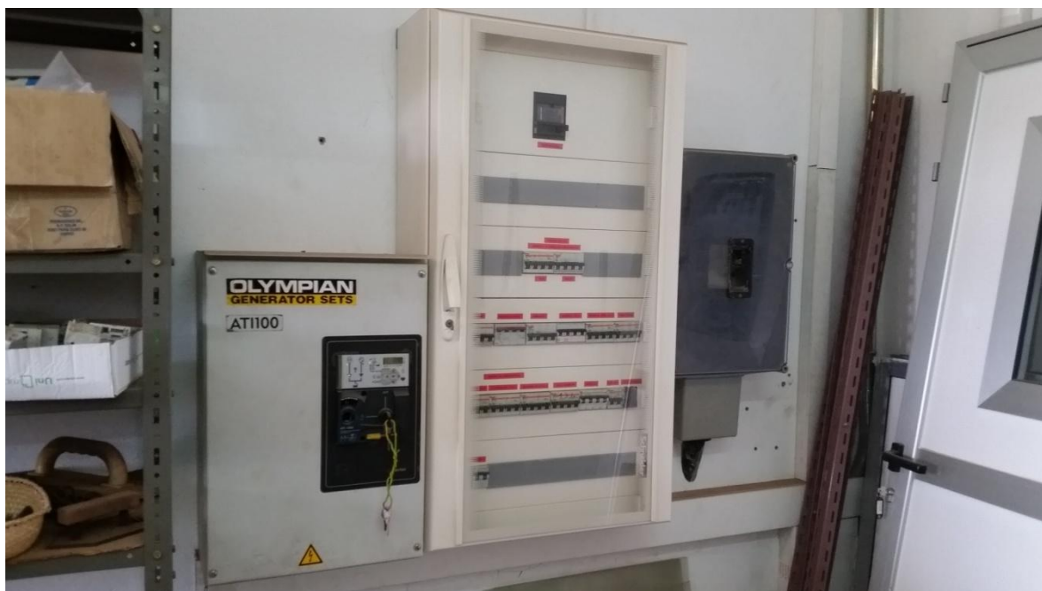
Imagen nº 25. Cuadro eléctrico general y cuadro eléctrico generador de emergencia. Fuente: Iván Tejera.
