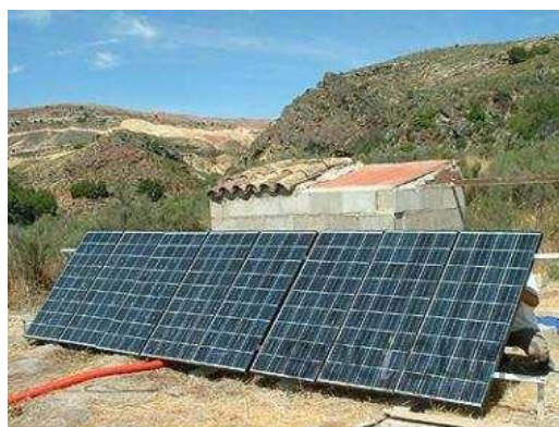
Figura 9. Ilustración de un generador solar fotovoltaico sobre suelo conectado a red
