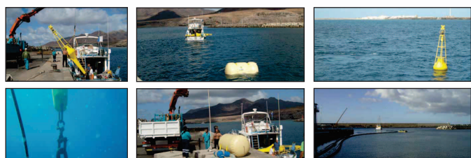
Maniobras de montaje y fondeo del balizamiento, señalización perimetral y remolque de los smartlines ensamblados.
