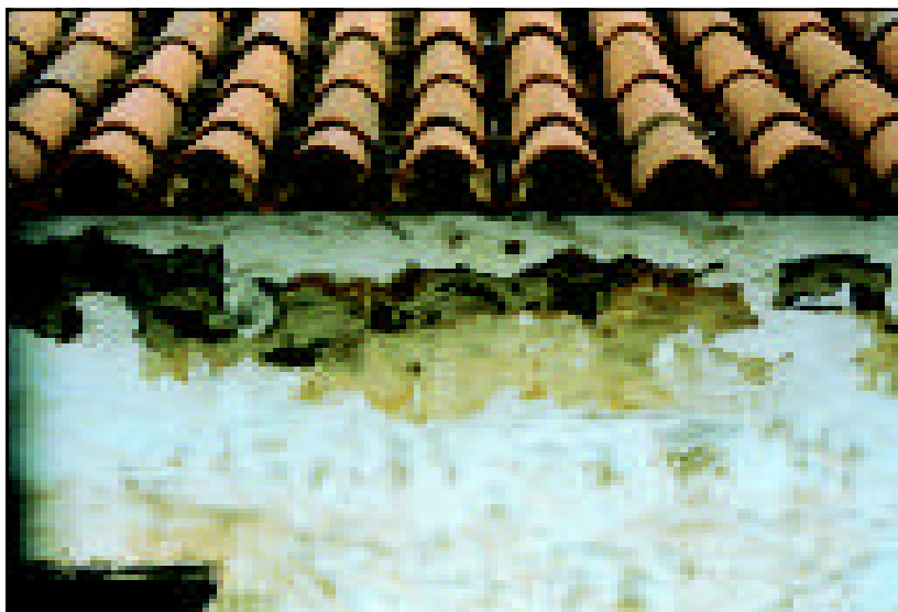
Ejemplo del deterioro de las paredes del edificio, y del techo.
