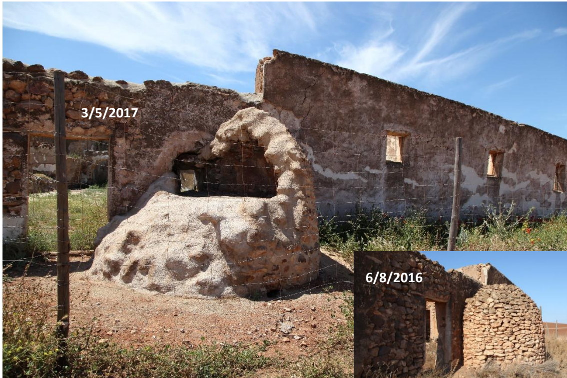
Fotografía 15.60: afectación del horno de pan del Cortijo del Fraile por la segunda fase de la consolidación. En la esquina derecha inferior de la imagen, se sobre-impone el aspecto original que tenía este horno en el verano de 2016. En el periodo de tiempo entre la afectación de la consolidación y el verano de 2016 no hubo lluvias de consideración, que pudieran destruir al horno. Captura del 3 de mayo de 2017.
