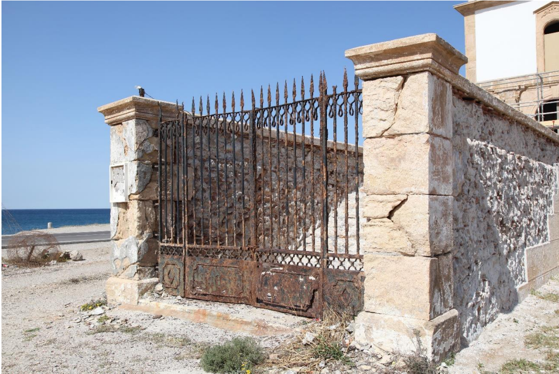
Fotografía 15.49: estado de situación de la reja que franquea a la escalinata de entrada a la Iglesia de las Salinas del Cabo de Gata, durante los trabajos de restauración y de habilitación. Captura del 23 de marzo de 2012.
