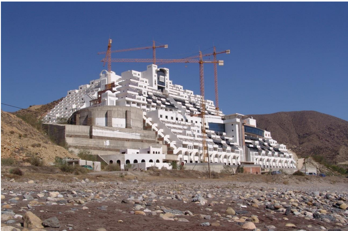
Fotografía 15.34: obras paralizadas de un hotel en la Playa de Algarrobico, y a la espera de su demolición por representar una actuación incompatible en el Parque Natural del Cabo de Gata-Níjar. Captura del 15 de agosto de 2008.
