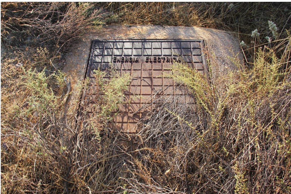
Fotografía 15.40: arqueta del cableado eléctrico soterrado a lo largo de la divisoria de aguas de La Rellana (Parque Natural de Cabo de Gata-Níjar), Captura del 20 de agosto de 2010.
