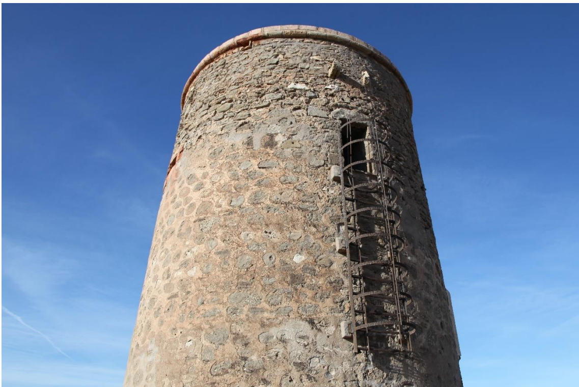
Fotografía 12.18: Torregarcía. Detalle de la actual escalera externa de acceso. Captura del 31 de marzo de 2018.
