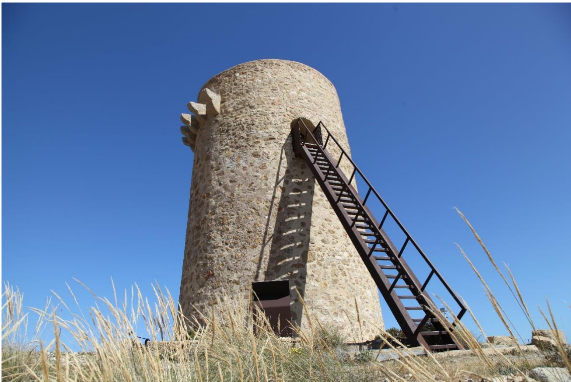
Fotografía 12.24: Torre del Rayo, entre Carboneras y El Algarrobo, tras una reciente restauración (entre 2010 y 2011). Captura del 26 de abril de 2019.
