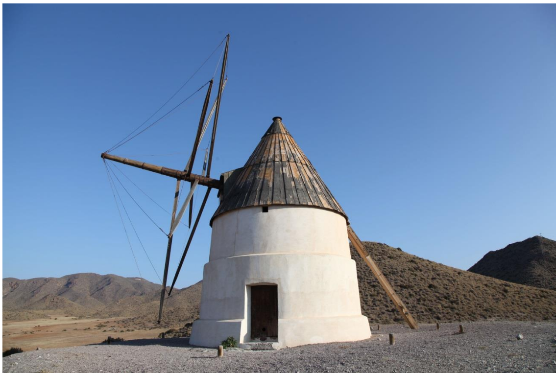
Fotografía 12.106: deterioro de la pintura protectora del chapitel del molino del Collado de Los Genoveses, o del Cerro del Avemaría (Parque Natural de Cabo de Gata-Níjar, Almería). Captura del 31 de julio de 2014.
