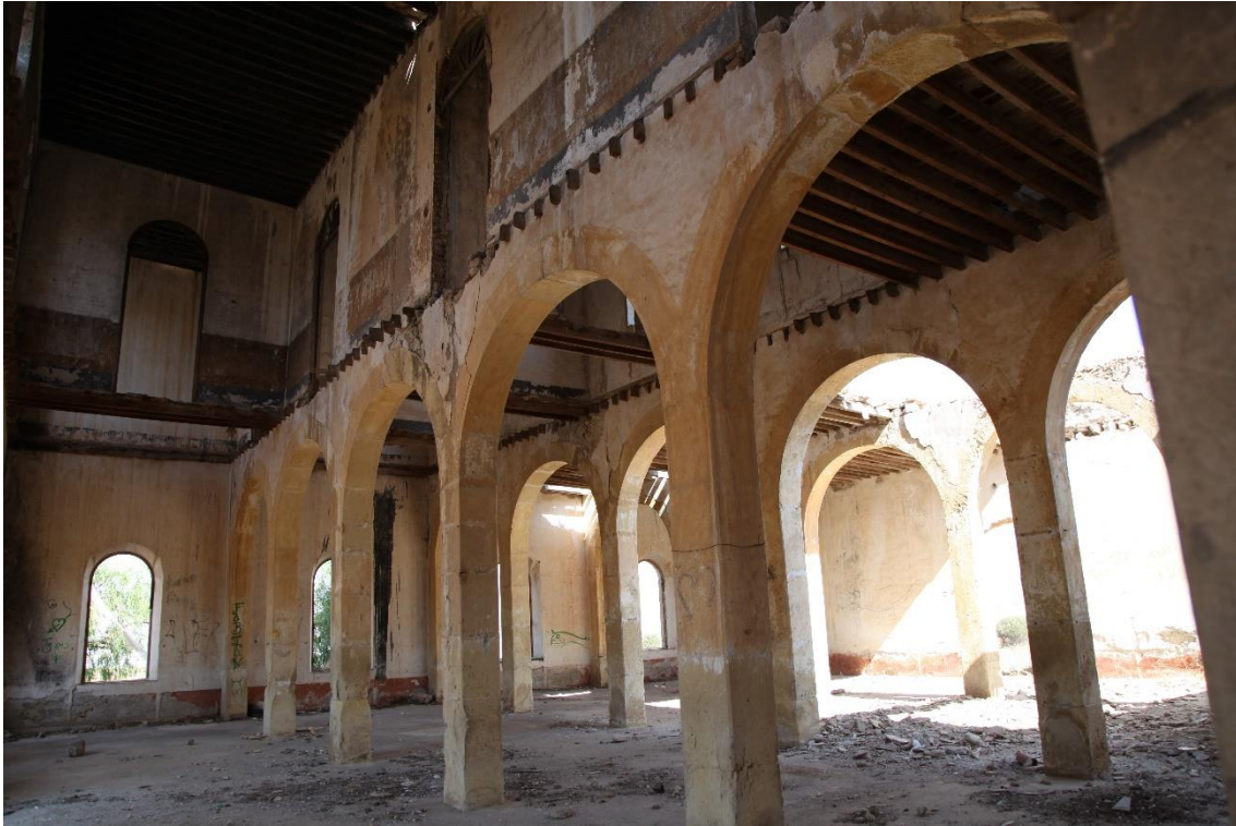
Fotografía 12.71: interior del edificio principal del Cortijo Cayuela, en ruinas, con los almacenes en la planta baja y la vivienda de los dueños en la planta superior. Captura del 29 de julio de 2017.
