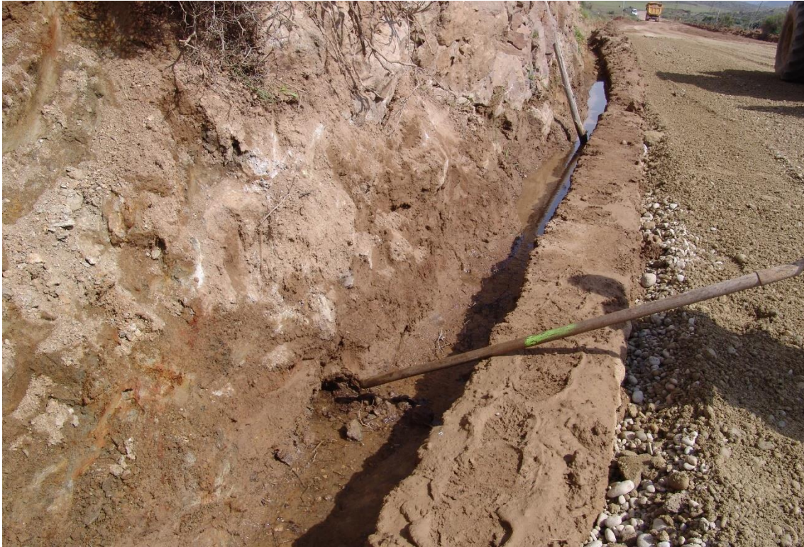
Fotografía 2.48: durante la reparación del camino entre Vela Blanca y San José, afectado por la surgencia del 15 de marzo de 2010, aún manaba agua de una de las bocas (donde se encuentra la base del palo, a pie de la imagen). Los autores hicieron el seguimiento de la reparación y disponen de las medidas técnicas aplicadas. Captura del 25 de marzo de 2010.
