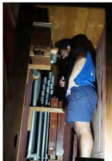
Fig. 4. Detalle del trémolo no original y fugas solucionadas de manera provisional.
