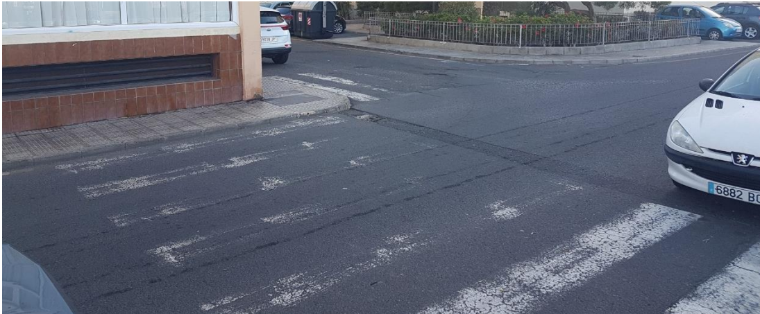
Imagen 30. Intersección calle Yágabo – calle Caldera de Taburiente. Arrecife. Marcas viales en mal estado.
