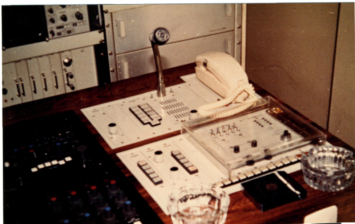
Cuadro de intercomunicación
