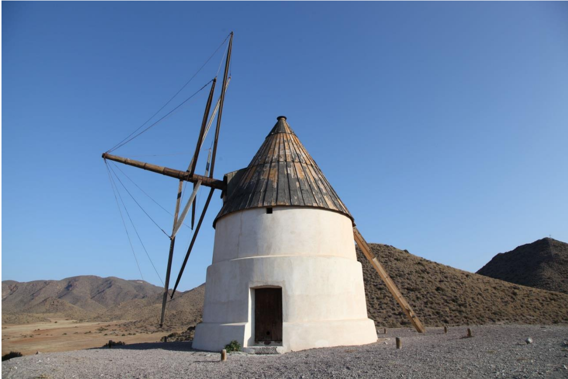
Fotografía 8.92: deterioro de la pintura protectora del chapitel del molino del Collado de Los Genoveses (Parque Natural de Cabo de Gata-Níjar, Almería). Captura del 31 de julio de 2014
