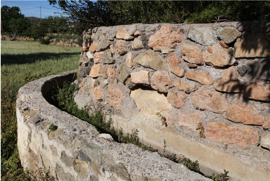
Fotografía 8.59: acequia de obra en El Cerrillo, para el riego a manta, o simplemente para conducción de agua, en las proximidades de la Villa de Níjar. Esta zona está en la cabecera del Campo de Níjar. Captura del 3 de mayo de 2017
