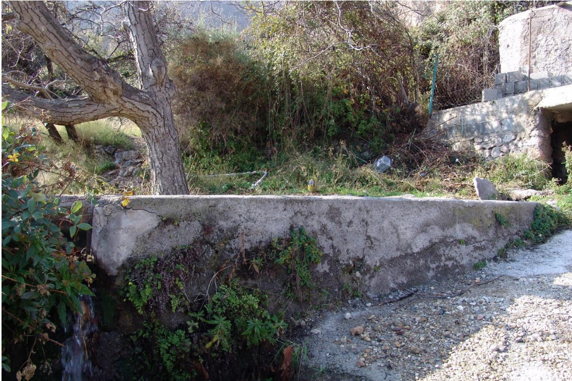
Fotografía 8.113: salida de un tramo de acequia desde la parte inferior del primer molino de agua, en la cabecera del Valle de Huebro, hacia el cubo del siguiente, aguas abajo. Captura del 29 de diciembre de 2007
