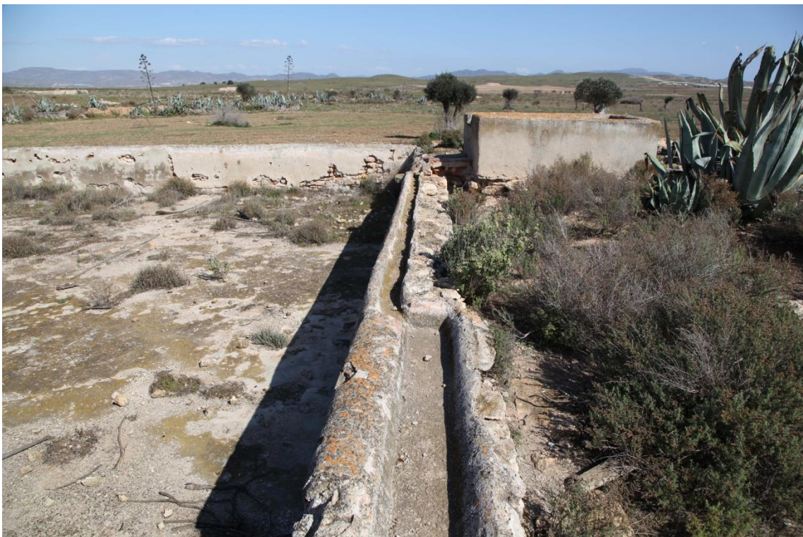
Fotografía 8.50: conducciones del agua desde el depósito de distribución (a la derecha) a la mareta y a la acequia de servicios. Captura del 3 de marzo del 2012
