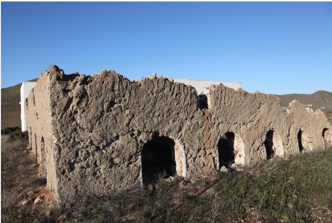
Fotografía 8.74: observación de la fachada oriental de lo que queda del sestero ganadero de doña Paca Góngora, en Boca de Los Frailes. Para la toma fotográfica, se empleó, colocada fuera de la propiedad, unas escaleras de mano para superar el impacto negativo visual, de una valla de tela metálica, en la imagen del patrimonio pecuario del pasado reciente. Captura del 22 de marzo de 2018
