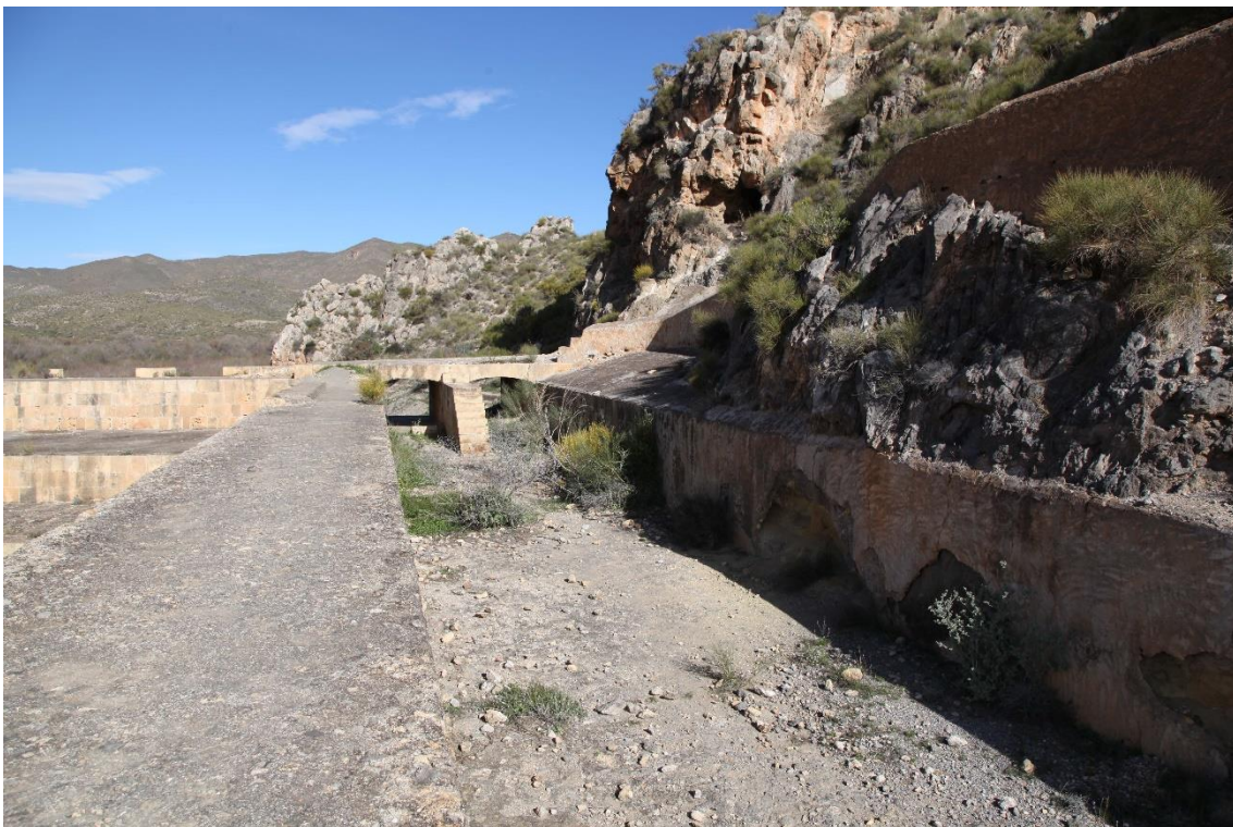
Fotografía 7.11: vista, aguas arriba, del tramo inicial del canal doble del aliviadero, en la margen izquierda de la culminación del muro, (aguas abajo de la Rambla). El canal doble tiene unos 440 cm de ancho y 140 cm de alto. Recorre una longitud de casi unos 70 m, y tiene una salida a la Rambla. Captura del 19 de marzo de 2018
