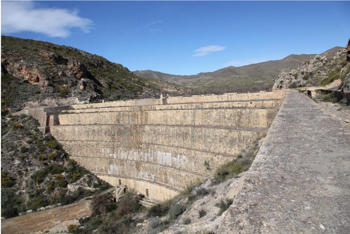
Fotografía 7.4: panorámica de la cara externa (opuesta al vaso) del muro arqueado de la presa del Pantano Isabel II, con sus dos hastiales (apoyos laterales), y con los aliviaderos (a la derecha). El muro tiene una longitud de unos 90 m en coronación, una altura de unos 30 m, una anchura de 20 m en la cota de la base del desarenador y de 43 m en la base de la obra, y una fachada externa en gradas. Al pie del muro, destaca el tramo inicial del canal de riego (Canal de Campo), para distribuir el agua que se hubiera acumulado. Un pantano lo conforma el vaso (donde se acumula el agua) y la presa. En la presa, se incluye el muro, los aliviaderos, la sala de las compuertas, el desarenador y otras construcciones adicionales. Captura del 19 de marzo de 2018
