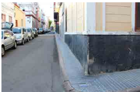
Figura 3. Acera de la calle Tanausú, esquina calle Tauro. Acera repuesta el año 2010, barrio de La Isleta.
