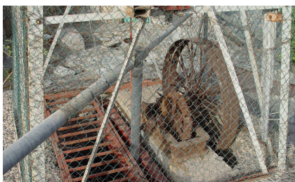
Detalles del tubo de descarga metálico del molino de viento aeromotor "Tipo Americano" en TM La Aldea de San Nicolás. Gran Canaria.
