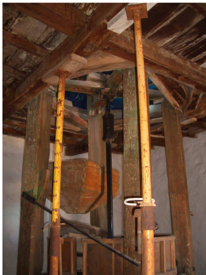
Detalle de la maquinaria de molturación en el interior del edificio del molino de viento "Sistema Romero" en Carrizal. TM de Ingenio. Gran Canaria.
