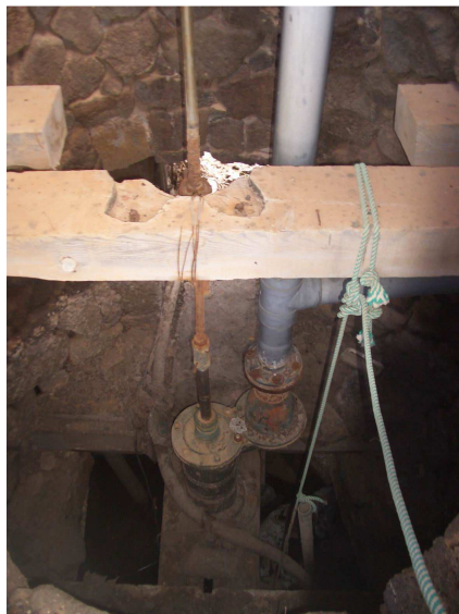
Detalle del vástago metálico, tubo de descarga y bomba de aspiración de pistón. Molino de viento "Salinero Canario". TM Tegui. Lanzarote.
