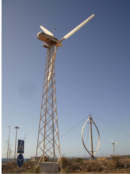
Detalle aerogenerador de media y baja potencia. Polígono industrial de Arinaga. TM Agüimes, Gran Canaria.
