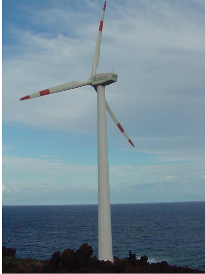
Molino de viento aerogenerador de torre tubular y rotor de tres palas en TM de Mazo. La Palma.
