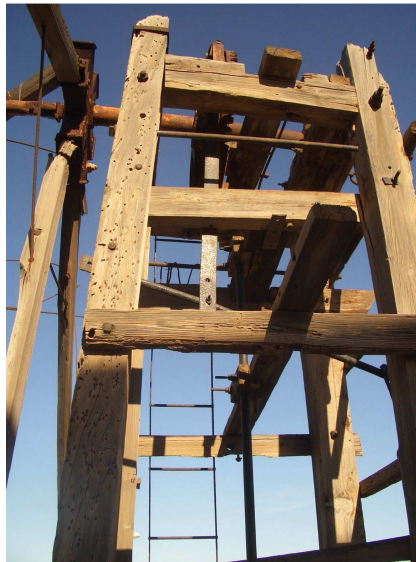
Detalle del eje metálico inclinado que sostiene el rotor de aspas y la rueda catalina del molino de viento "Sistema Romero" en Carrizal, TM de Ingenio, Gran Canaria.
