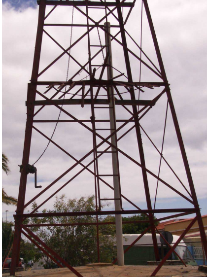
Detalle del freno manual mediante torno situado en la base de la torre metálica triangulada del molino de viento Aeromotor en TM de Ingenio. Gran Canaria.
