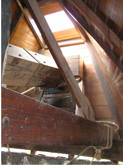
Detalle del eje inclinado del rotor. Molino de viento en TM La Antigua. Fuerteventura.
