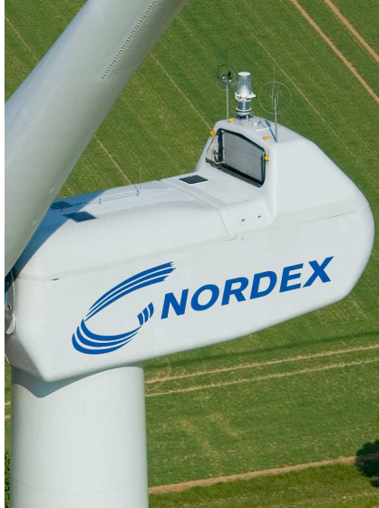
Sensores de velocidad y dirección del viento para la orientación del rotor y situados en la góndola de un aerogenerador de gran potencia de rotor tripala de la marca Nordex.
