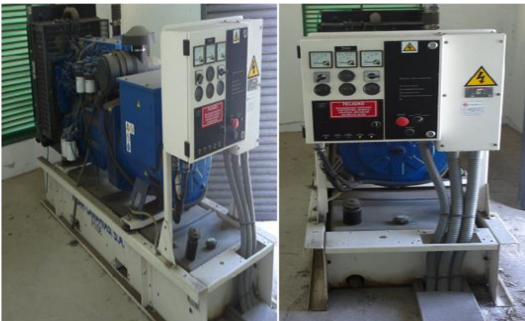
Figura 2.8 Grupo electrógeno CPD-I.
