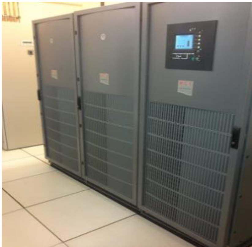
Figura 2.11 Sistema de Alimentación Ininterrumpida (SAI) CPD-I
