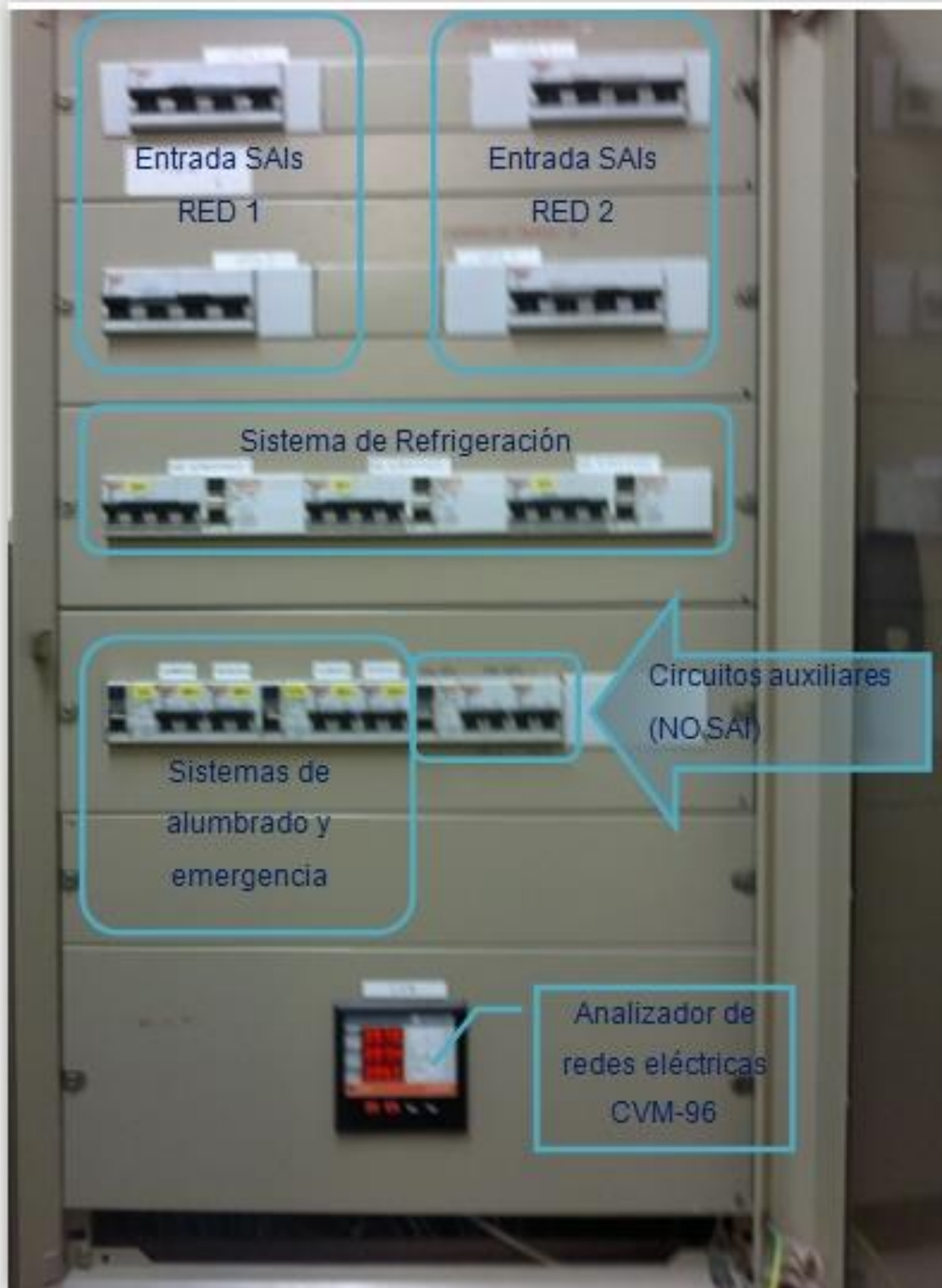
Figura 4.7 Cuadro eléctrico de entrada CPD-I
