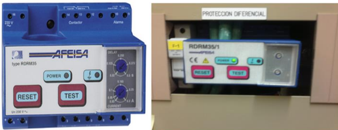
Figura 4.25 Diferencial de rearme RDRM35/1 [13] y una vez instalado
