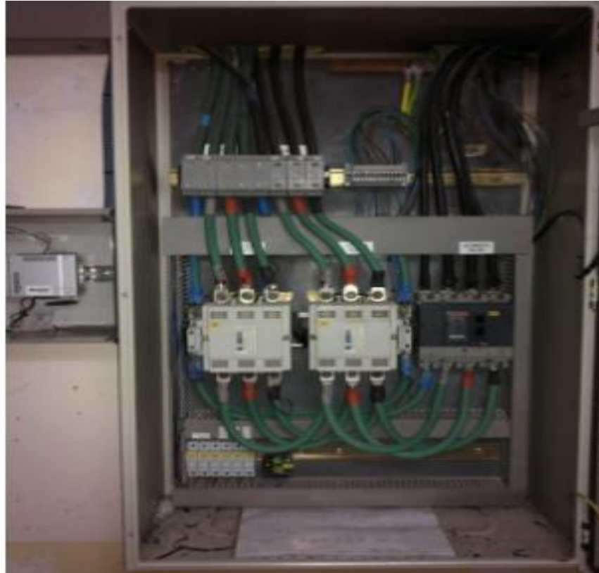
Figura 2.9 Cuadro eléctrico conmutación red-grupo
