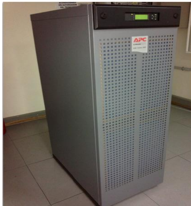
Figura 2.12 Sistema de Alimentación Ininterrumpida CPD-II.
