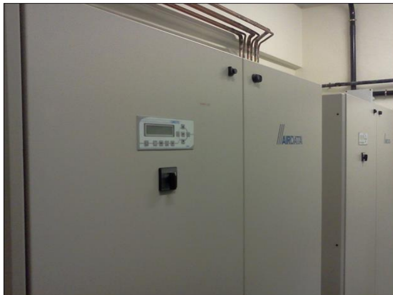
Figura 2.14 Vista de los sistemas de refrigeración en CPD-I
