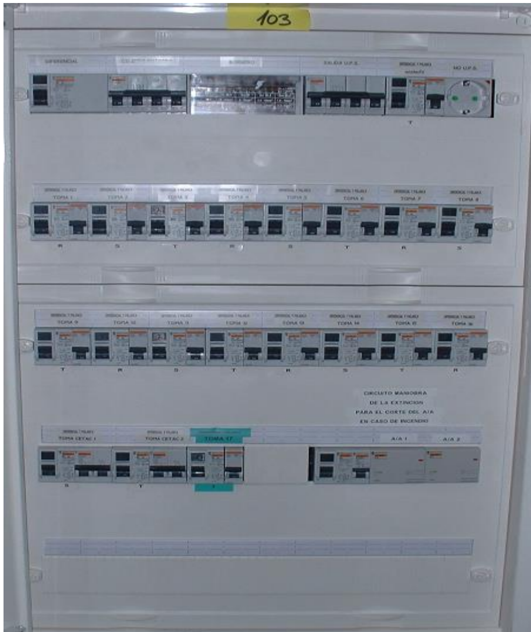
Figura 4.8 Cuadro eléctrico de entrada CPD-II
