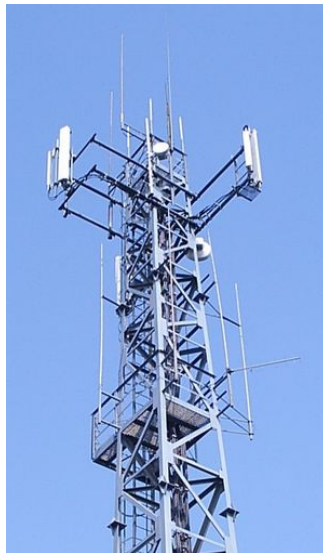
Figura 10: Estación base GSM
