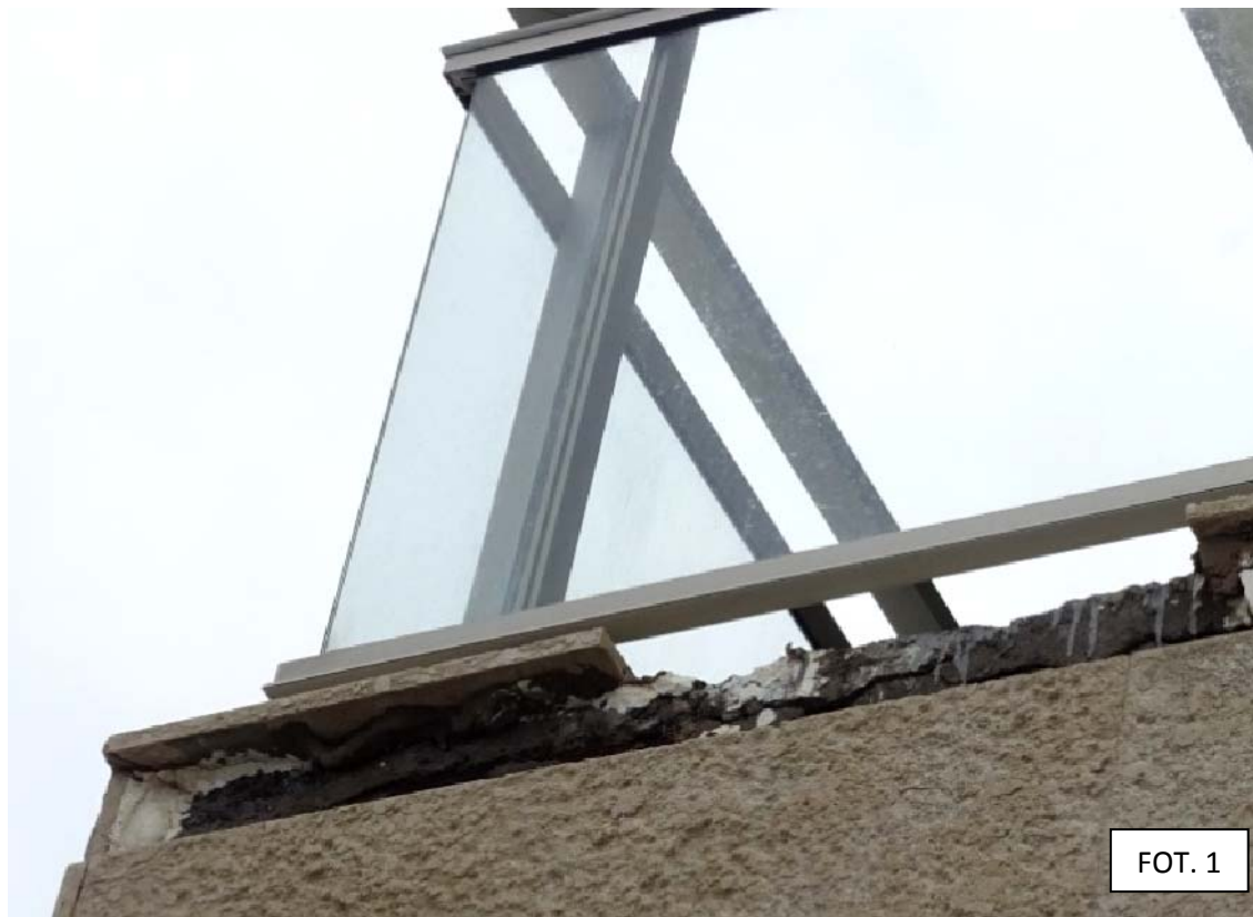
El aplacado que reviste el frente del balcón se ha desprendido, incluso con caída. No se aprecian vestigios de anclajes metálicos de las placas pétreas.
