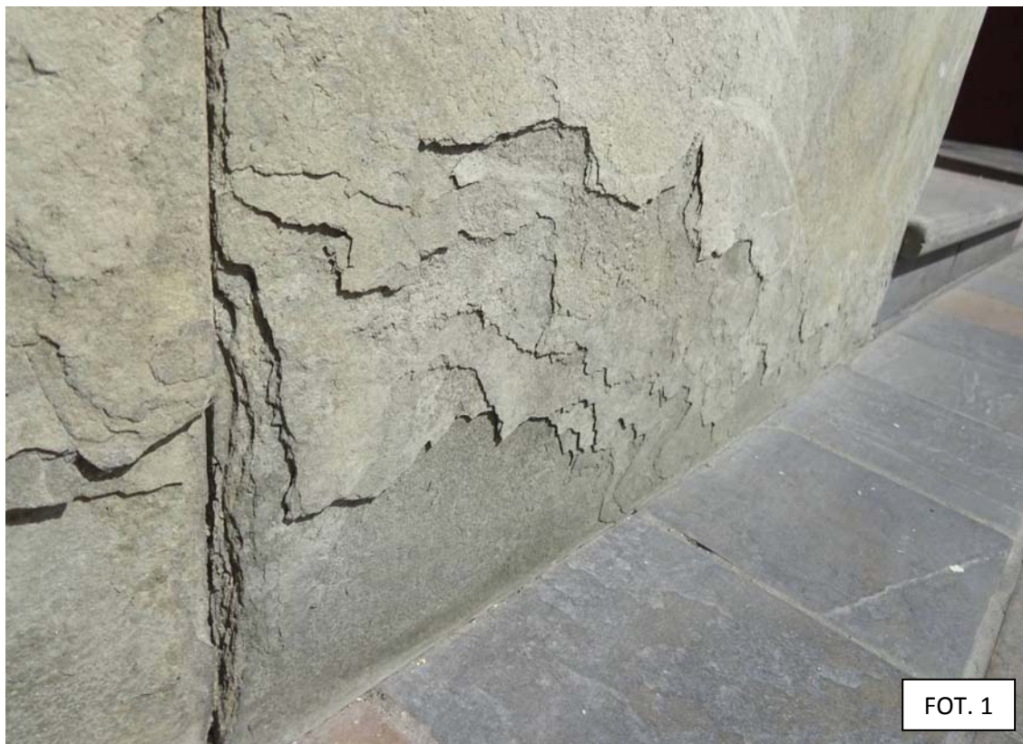
En la primera hilada del aplacado, directamente rematado contra el suelo, se advierte un proceso de disyunción en la piedra dada la manifestación de hojas de exfoliación.
