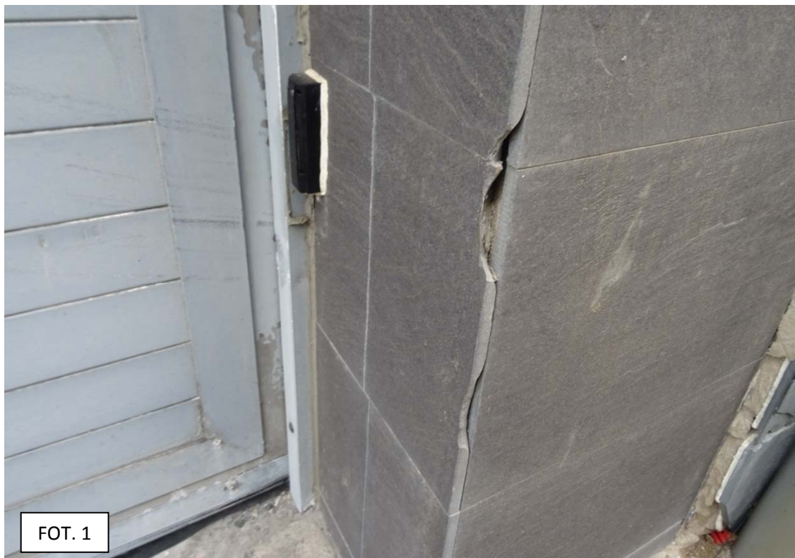
Se observa la rotura irregular del aplacado, con desprendimiento, sobre todo en el canto de las piezas pétreas perpendiculares al plano principal de fachada en el ámbito de la puerta de acceso al garaje.
