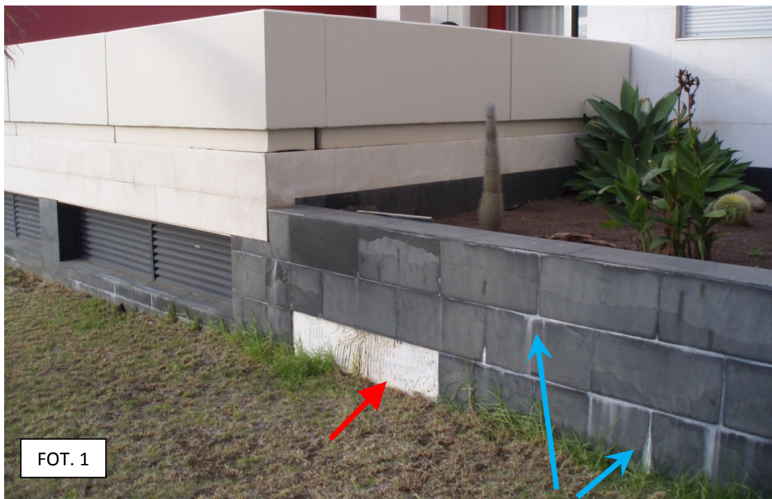
Se observa la caída de algunas placas, así como manchas blanquecinas aflorando por las juntas entre piedras.
