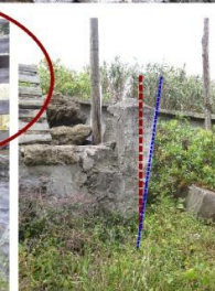
Desplazamiento por los empujes del terreno
