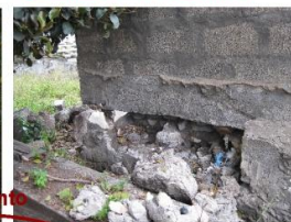
Caída de tramos del muro
