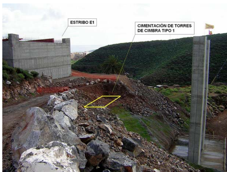
Foto 3. Ubicación de la cimentación tipo 1 de las torres de cimbra próximas al estribo E1 , objeto de este estudio. Obsérvese su disposición próxima al borde del talud.
