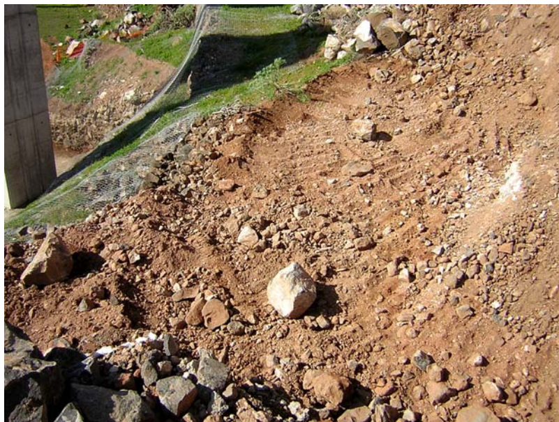
Foto 5. Detalle de la excavación en la ladera del barranco para la cimentación de las torres de cimbra sobre los depósitos aluviales antiguos en las proximidades del borde del talud.
