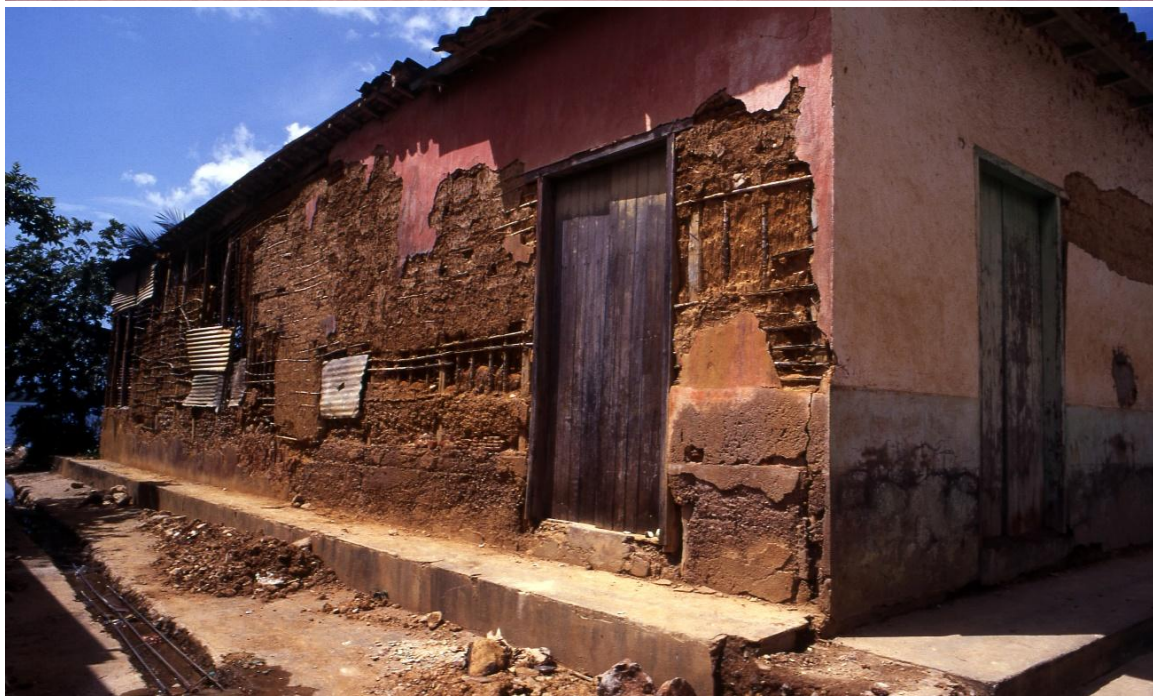
Fotografías 8.106 y 8.107: afectaciones del sismo del 9 de julio de 1997, causado por la Falla de El Pilar, a las casas de adobe de la Ciudad de Cariaco, en el extremo interno del Golfo de Cariaco (en su límite oriental). La falla de El Pilar funcionó como una falla de desgarre. Este funcionamiento se puede explicar por los empujes laterales de la Placa Sudamericana, en su avance hacia el oeste, en el límite meridional de la Placa Caribeña. Muchas de las numerosas réplicas sísmicas posteriores, a lo largo del mes de julio, pudieron estar causadas por asentamientos del terreno, mediante fallas normales. Capturas del 10 de julio de 1997.
