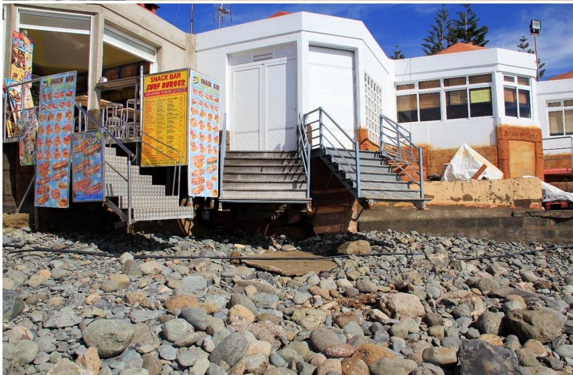
Fotografías 8.90 y 8.91: fachada marítima del Centro Comercial Oasis (entre El Faro y La Charca de Maspalomas). La imagen superior, con el fondo escénico del Campo de Dunas de Maspalomas, describe unos procesos constructivos de transporte y depósito sedimentario, dependientes de una dinámica marina y de otras actuaciones, que creó una acumulación de arenas en un paisaje sensorial urbano (captura del 25 de julio de 2011). La imagen inferior corresponde a un proceso de erosión y transporte , como repuesta a un temporal, que originó una superficie topográfica desnuda de arena ( forma destructiva ) en el paisaje sensorial urbano del lugar (captura del 20 de febrero de 2011).
