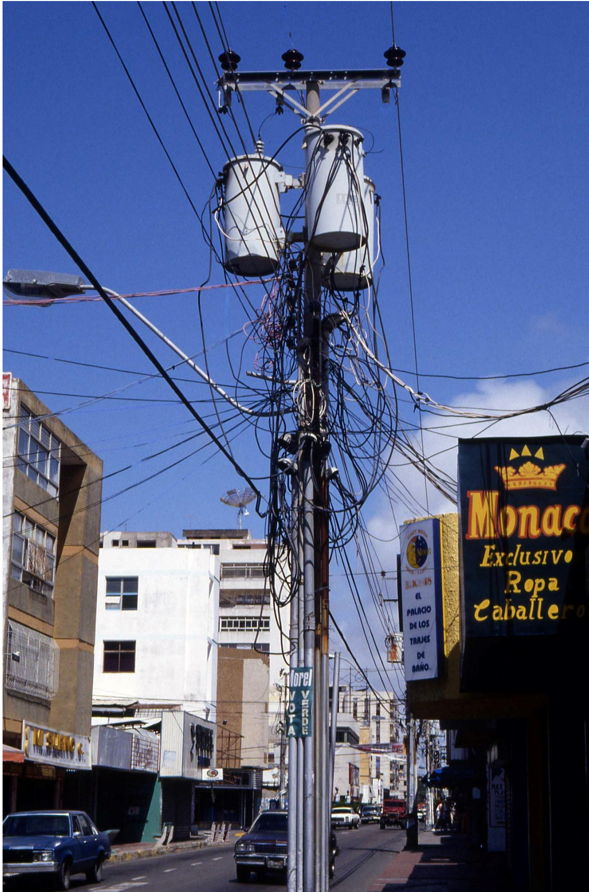
Fotografía 8.143: vista de un cableado y de transformadores pocos discretos. Calle Igualdad, casi con su cruce con la Avenida Santiago Mariño. Porlamar (Isla de Margarita, Venezuela). Captura del 26 de junio de 2000.
