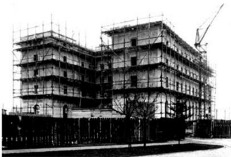
FIGURA 2. Estado de las obras del Colegio de España (París) en diciembre de 1930
