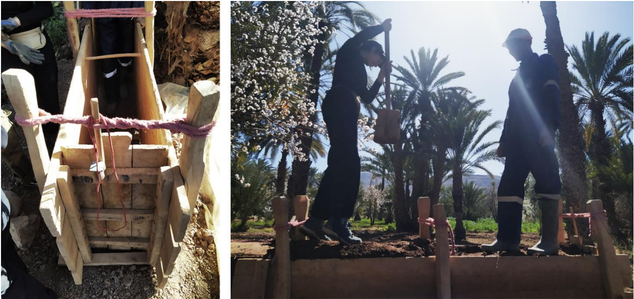
Fig. 43. Construcción de un muro con la técnica del tapial. Fotos del autor
