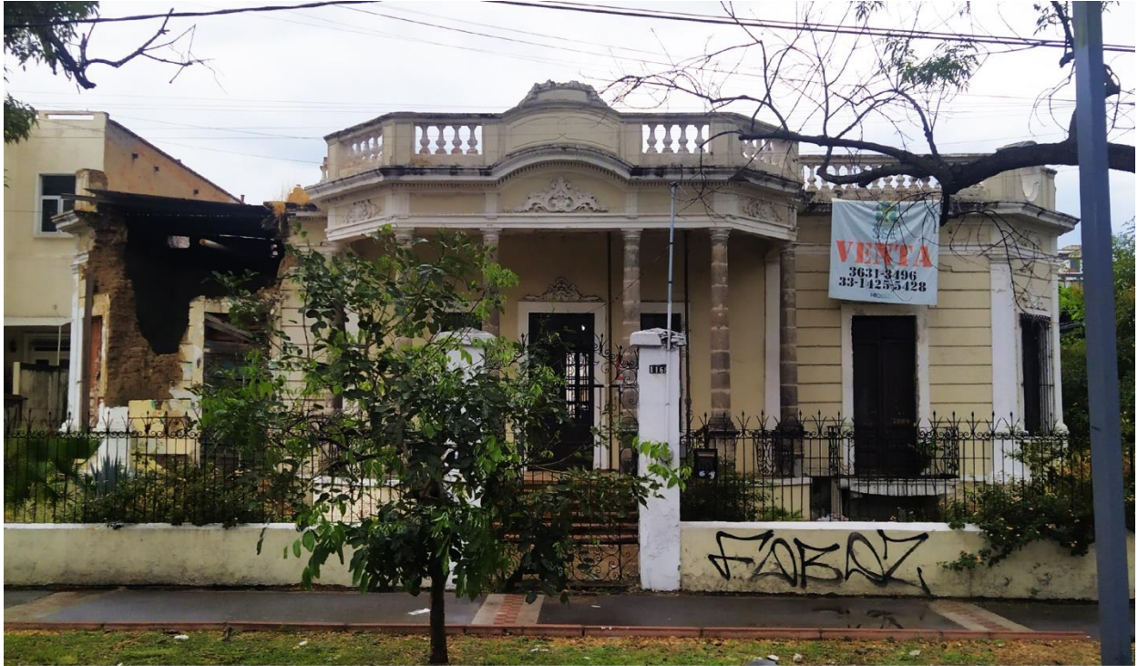
Fig. 31. Típico ejemplo de palacete de principio de siglo XX situado en la colonia Americana y en evidente y avanzado estado de deterioro. Foto del autor
