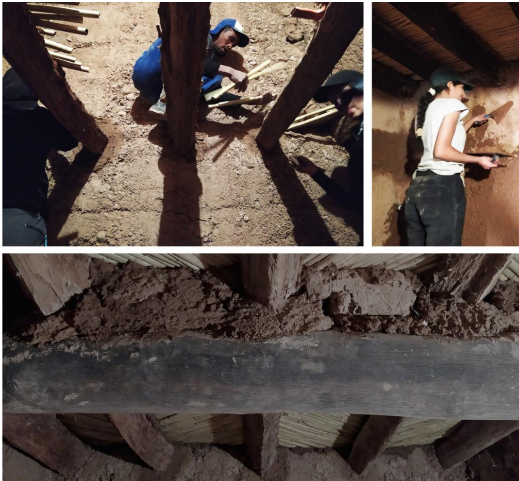
Fig. 42. Intervenciones en la Kasbah des Caid s. Nuevo forjado y revestimiento de las paredes. Fotos del autor
