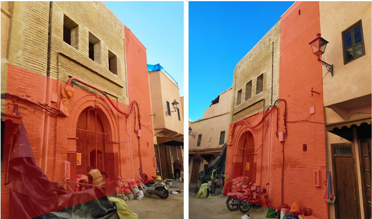
Fig. 57. Fachada de la Foundouk Moulay Boubker durante las obras. Resalte de las partes que no fueron sustituidas sino solo consolidadas. Elaboración propia
