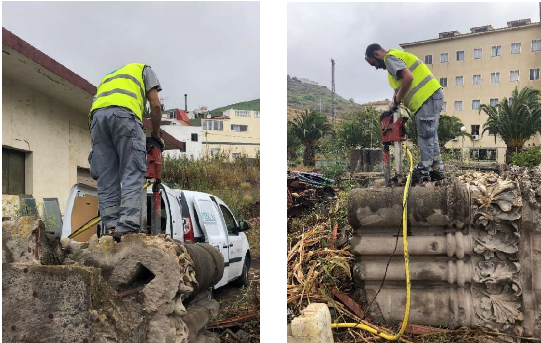
Figura 222. Operarios del Laboratorio Labetec realizando la extracción de testigos en los restos de los capiteles del seminario Diocesano de Tenerife para posterior ensayo de los mismo. Fotografías del autor
