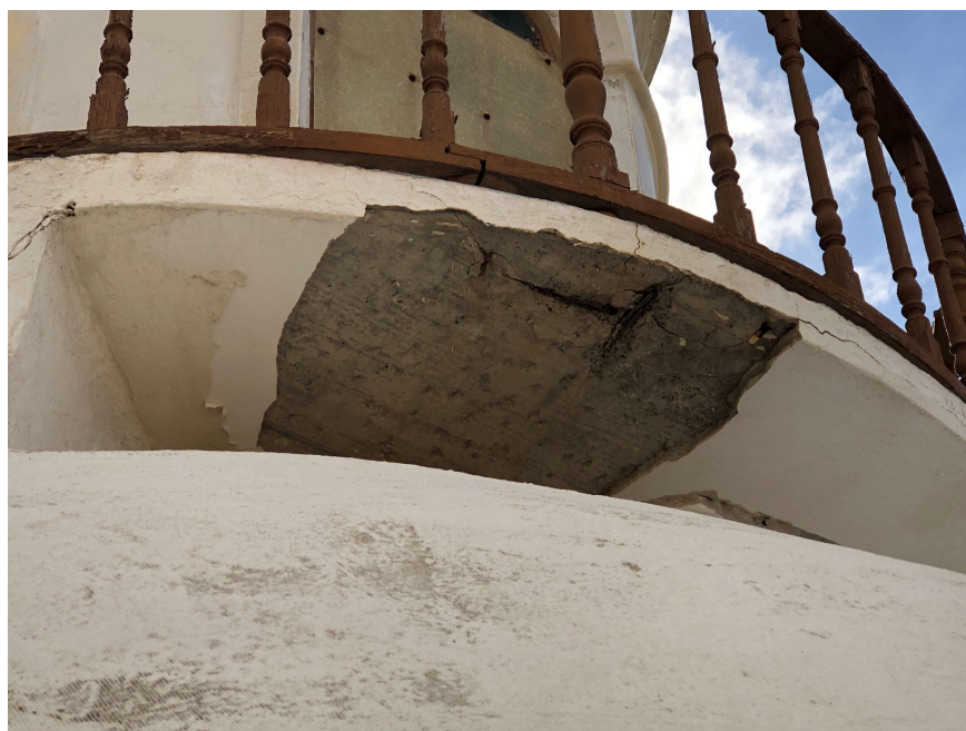
Figura 113, Sobre el casquete de la cúpula se desarrolla un mirador alrededor de la linterna. En la imagen, detalle de la losa de hormigón armado con importantes problemas de corrosión debido a la agresividad del ambiente marino. La Iglesia está situada a escasos 100 metros del mar, en la zona del istmo, junto a la playa de las Canteras. Fotografía del autor
