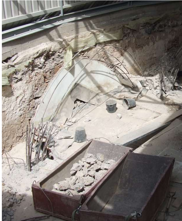
Figura 235: detalle de la armadura de los arcos en la zona de la girola durante la fase de demolición. Fotografía cedida por Víctor Rodríguez e hijos, responsables de la obra de demolición de las cubiertas.
