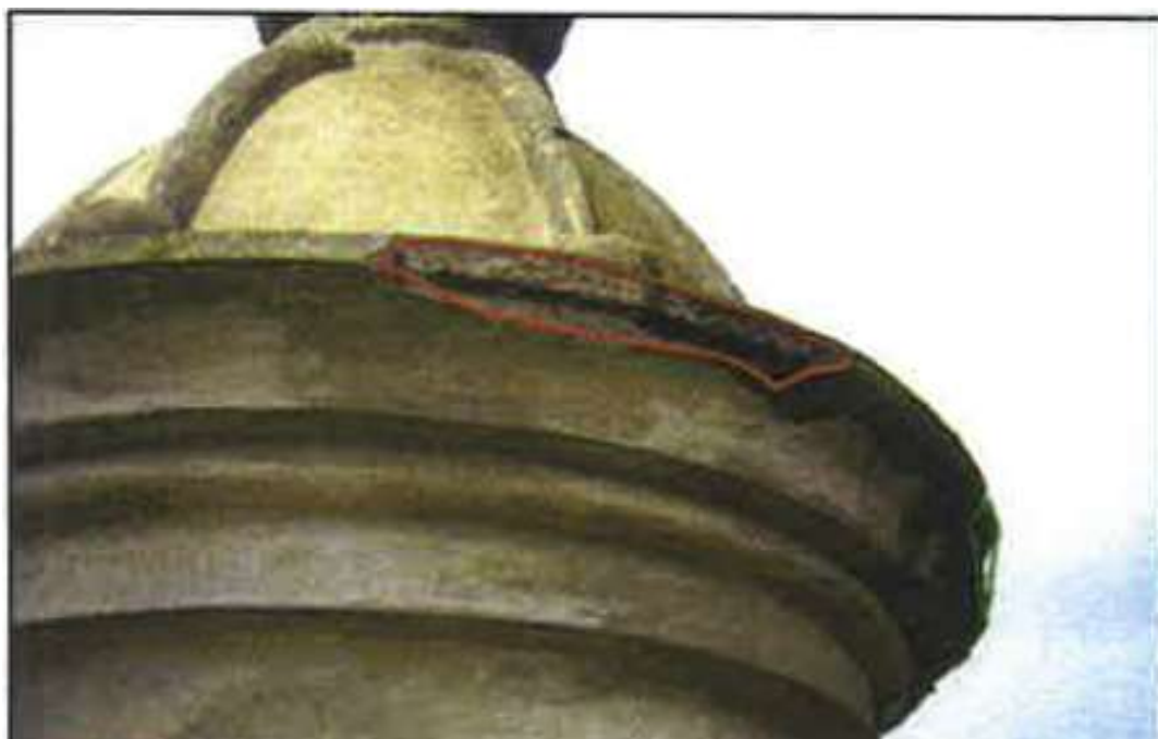
Figura 215, Rotura y desprendimiento de la corina del templete de remate superior de la cúpula, Imagen del Informe 19261 del IETcc
