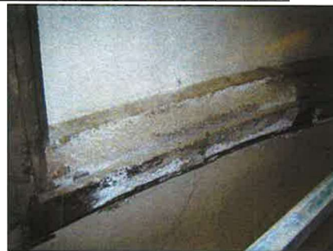
Figura 209, interior de la cúpula mirando hacia la nave principal. Principales daños: humedades y desprendimientos de recubrimientos de hormigón en arcos y cornisas. La todo muestra las eflorescencias en la cornisa interior a la altura del arranque de la cúpula. Imagen del informe nº 19261 del IETcc.
