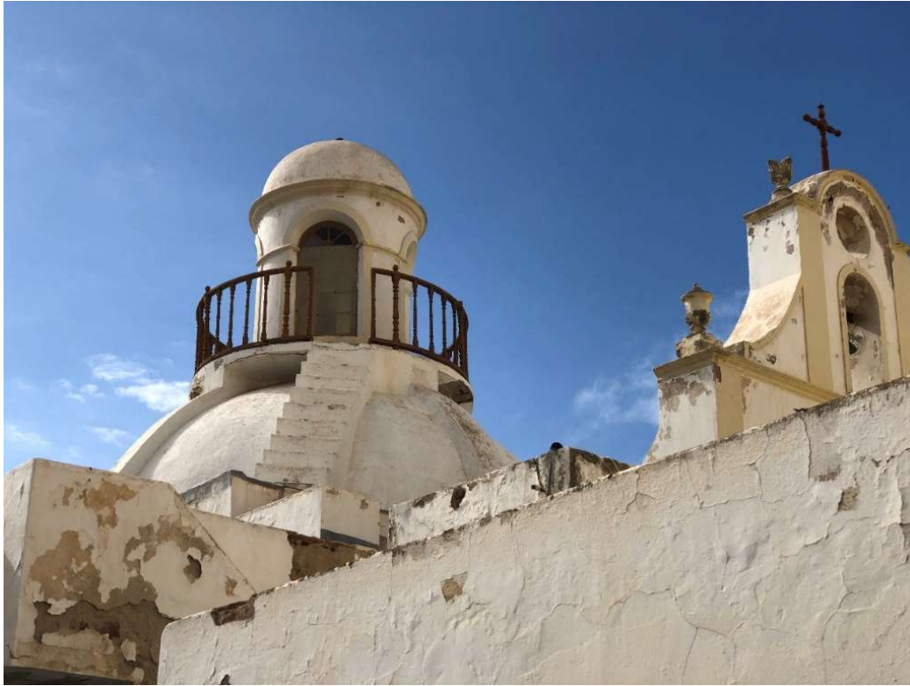
Figura 110, detalle de la cúpula de hormigón armado, Iglesia de San José (1905-1910). Fotografía del autor.
