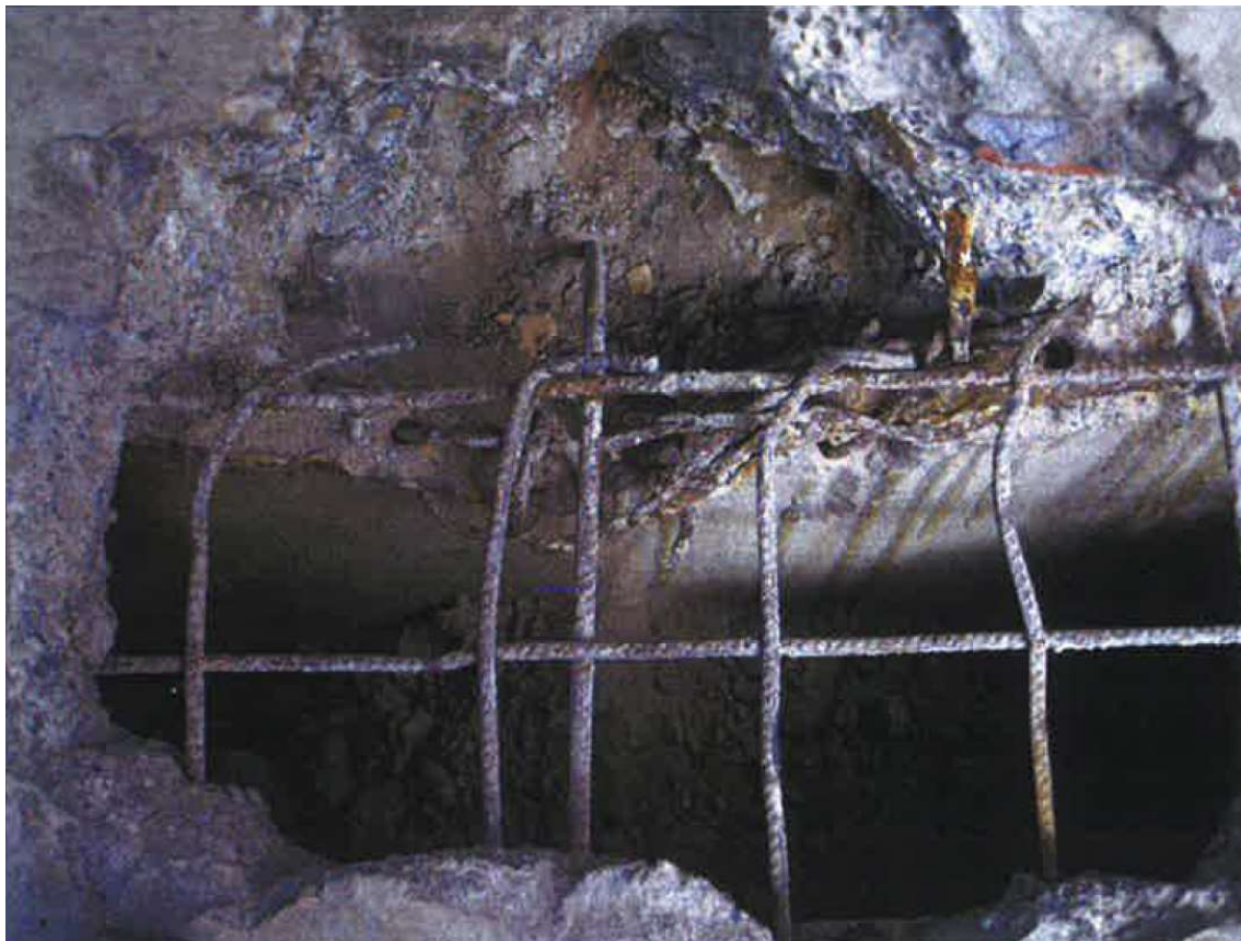
Figura 180, cala realizada por el IETcc en la losa superior de la cornisa decorativa remate del tambor. La armadura es corrugada lo que indica que esta parte de la cornisa es una reconstrucción, probablemente de los años 80, realizada por el arquitecto Sebastián Delgado.
