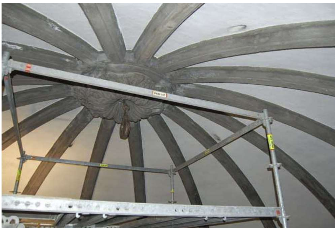
Figura 216: Vista interior de la clave de la cúpula en el momento de realizar la investigación para el informe 19261-I. Nivel de conservación de los nervios y el florón central.
