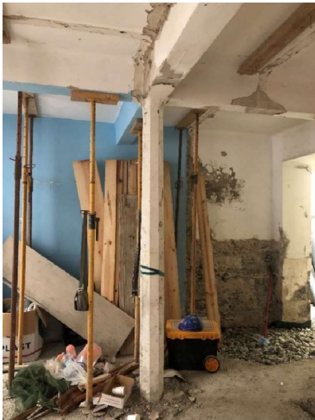
Figura 98 Pilar de hormigón armado de planta octogonal en la vivienda de la Calle Malteses, año 1916, Foto del autor
