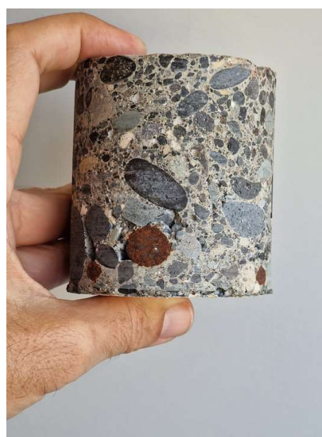
figura 92, resultados de los ensayos de las barras de acero de los forjados de bormigón armado y detalle del testigo extraído del forjado con las armaduras seccionadas, Iglesia las Hermanitas de los Ancianos Desamparados de Laureano Arroyo. Imágenes facilitadas por Alejandro García Medina, arquitecto
