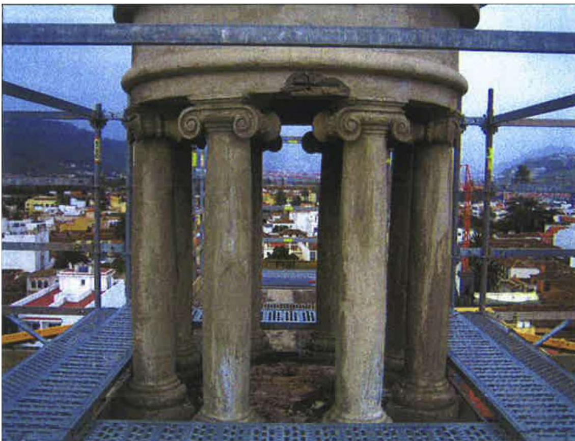
Figura 188, imagen del remate de la cúpula, constituido por un cupulín o templete apoyado sobre 8 columnas de hormigón armado de 30 cm de diámetro. Fotografía del informe nº 19261 del IETcc. Obsérvese la aparente deficiencia existente para la evacuación del agua de lluvia.
