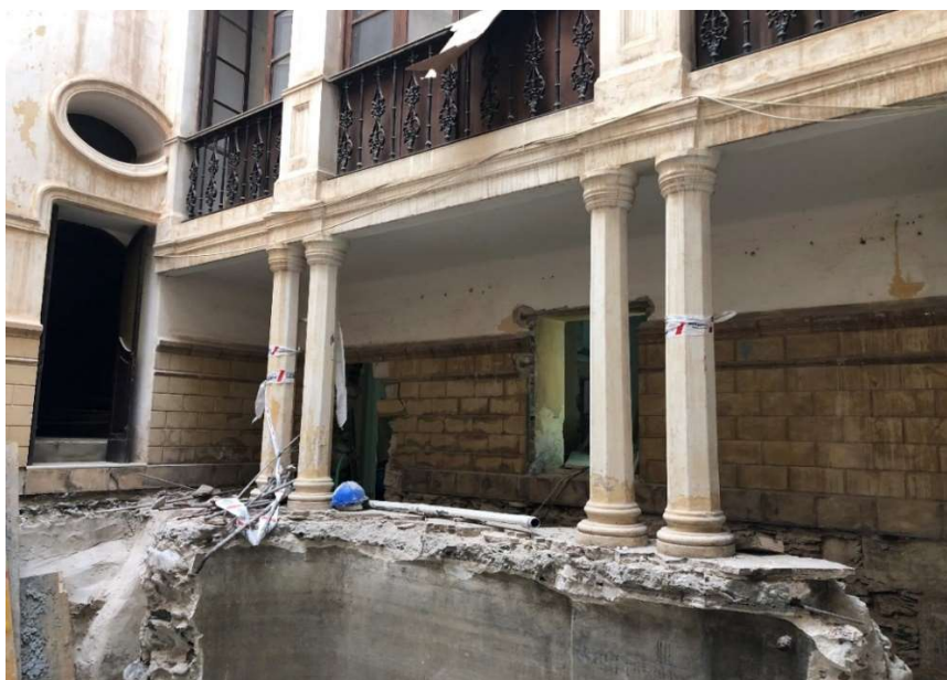
Figura 99. Los pilares de la planta baja, en un patio interior, situados sobre el aljibe de la casa. Destaca la cuidada elegancia de esos pilares clásicos. El aljibe con sus muros de hormigón de cal, el techo del aljibe con hormigón de cemento y armado. Fotografía del autor, año 2019.
