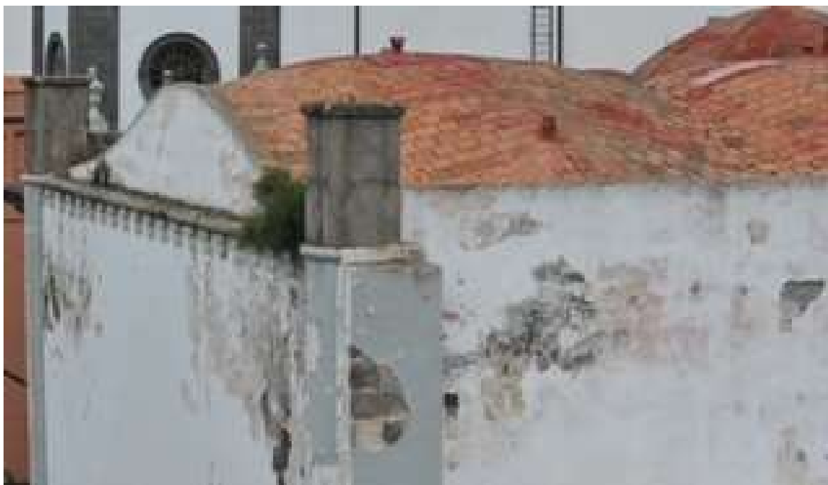
Figura 205, cubiertas de la Capilla de Sagrario revestidas de baldosines cerámicos y con algunos parches de reparación, humedades importantes en los cerramientos de fachada. Fotografía del archivo del periódico El Día.
