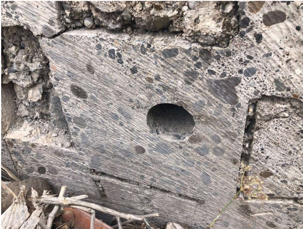
Figura 150: obsérvese las distintas calidades dlos hormigones utilizados en el núcleo resistente y los rellenos. Las juntas entre ambos materiales con los paramentos perfectamente definidos lo que denota la utilización de encofrados y distintas fases de hormigonados. En el centro, se observa el hueco dejado por la extracción de uno de los testigos realizados para esta investigación. Foto del autor.
