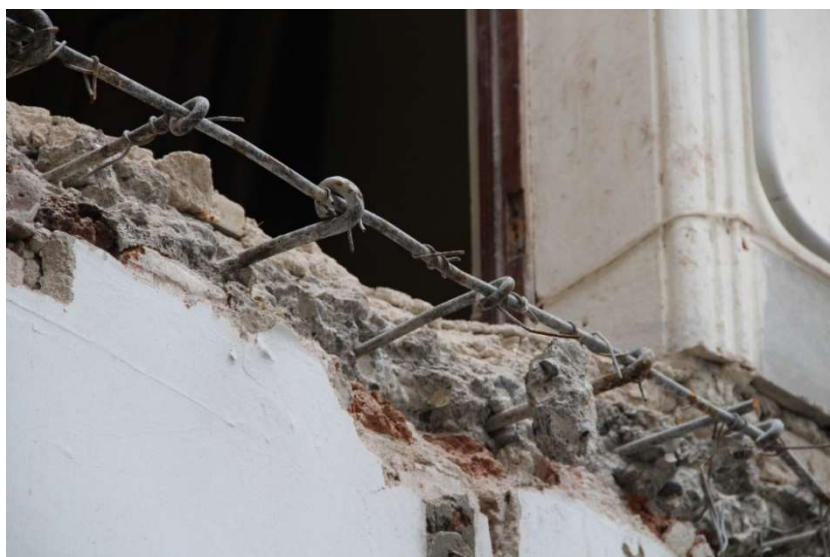
Figura 100, detalle del armado de la losa de forjado: los ganchos del final del armado se doblan en modo alterno sobre la última barra. La separación entre barras es muy homogénea de lo que se desprende un preciso trabajo de ferralla. Las armaduras presentaban en la visita pocos puntos de corrosión dada la antigüedad del hormigón. La foto, realizada por el autor, es del año 2019
