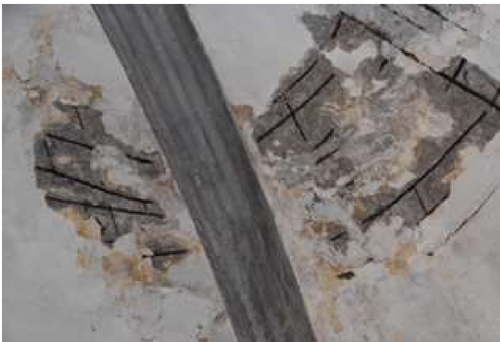
Figura 204: detalle de los daños en el interior de una de las bóvedas de la Catedral. Fotografía del Archivo del periódico El Día.
