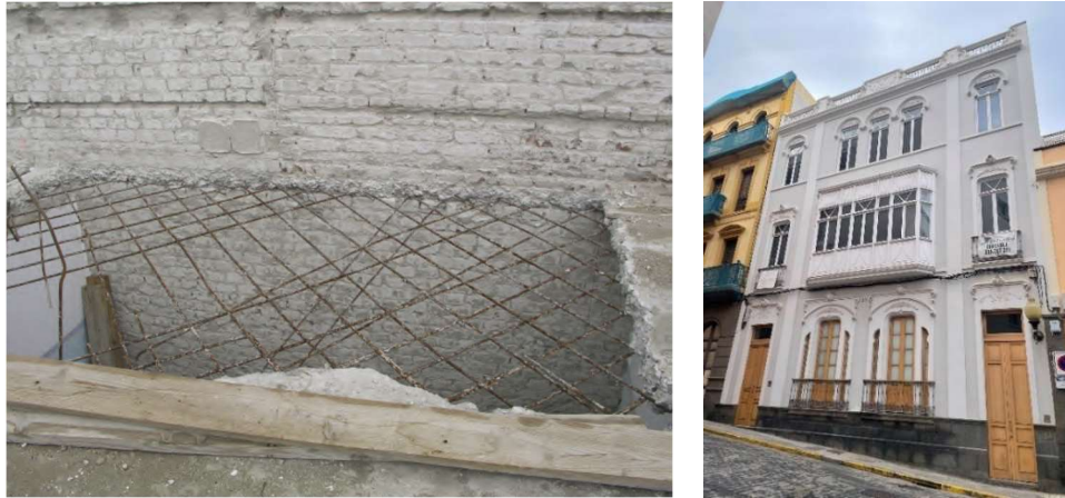
Figura 93, a la izquierda: losas de hormigón armado, años 1908-1911, en la calle Domingo J. Navarro. Foto de la Tesis Doctoral de Gazmira Galtier Barroso. A la derecha estado actual de la fachada, fotografía del autor.
