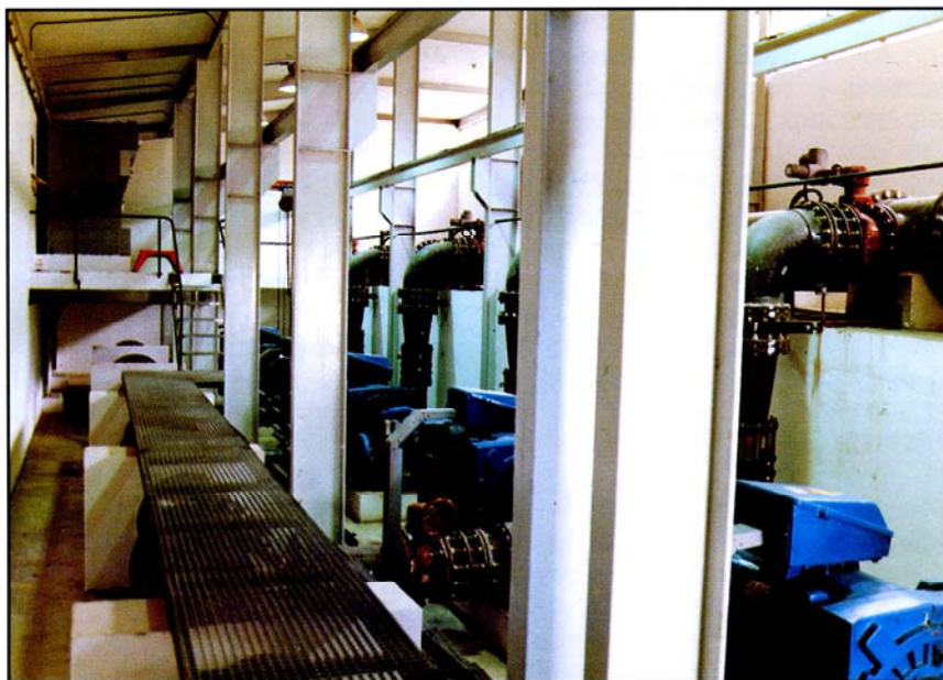
Estación de Impulsión de Agua Tratada del Fondillo (Tafira)
