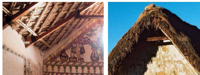
Figura 9: Carga muerta a la armadura: izquierda, estructura secundaria de faldones. Derecha, cobertura de paja sobre estera de totora. Imágenes de obras de restauración de la Fundación Altiplano.
