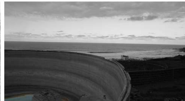
ESTRUCTURA DEL ESTANQUE EN ABANDONO
