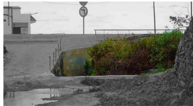
VEGETACIÓN DESCONTROLADA Y EN ABANDONO
