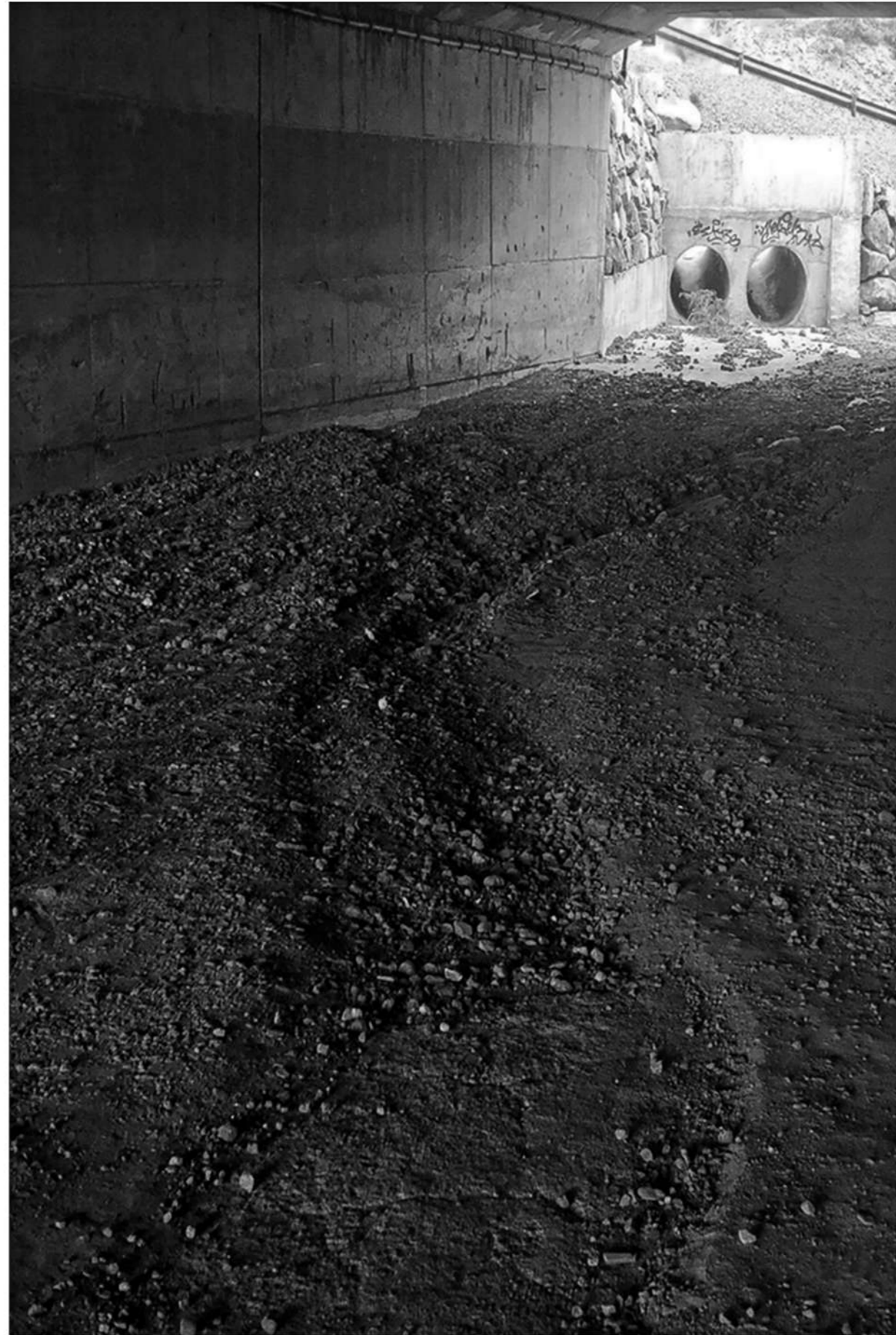
Escorrentías y restos de piedras, se aprecia la zona asfaltada.
