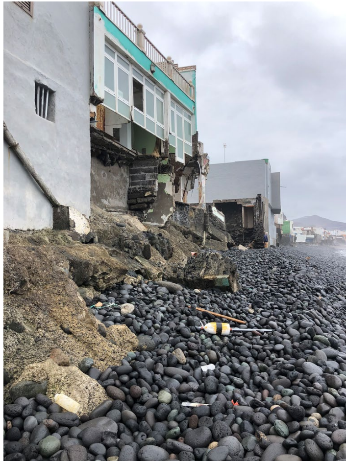
Fig. 2 Casas afectadas por el cambio climático. Fuente: Los autores (2022)
