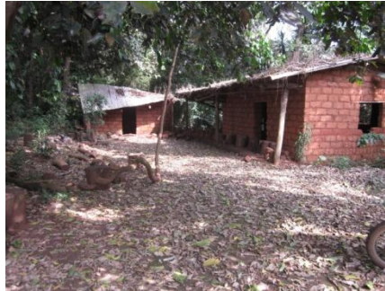
Photo 13. Etat de délabrement du lieu sacré de Foomenchui à Dzikop
