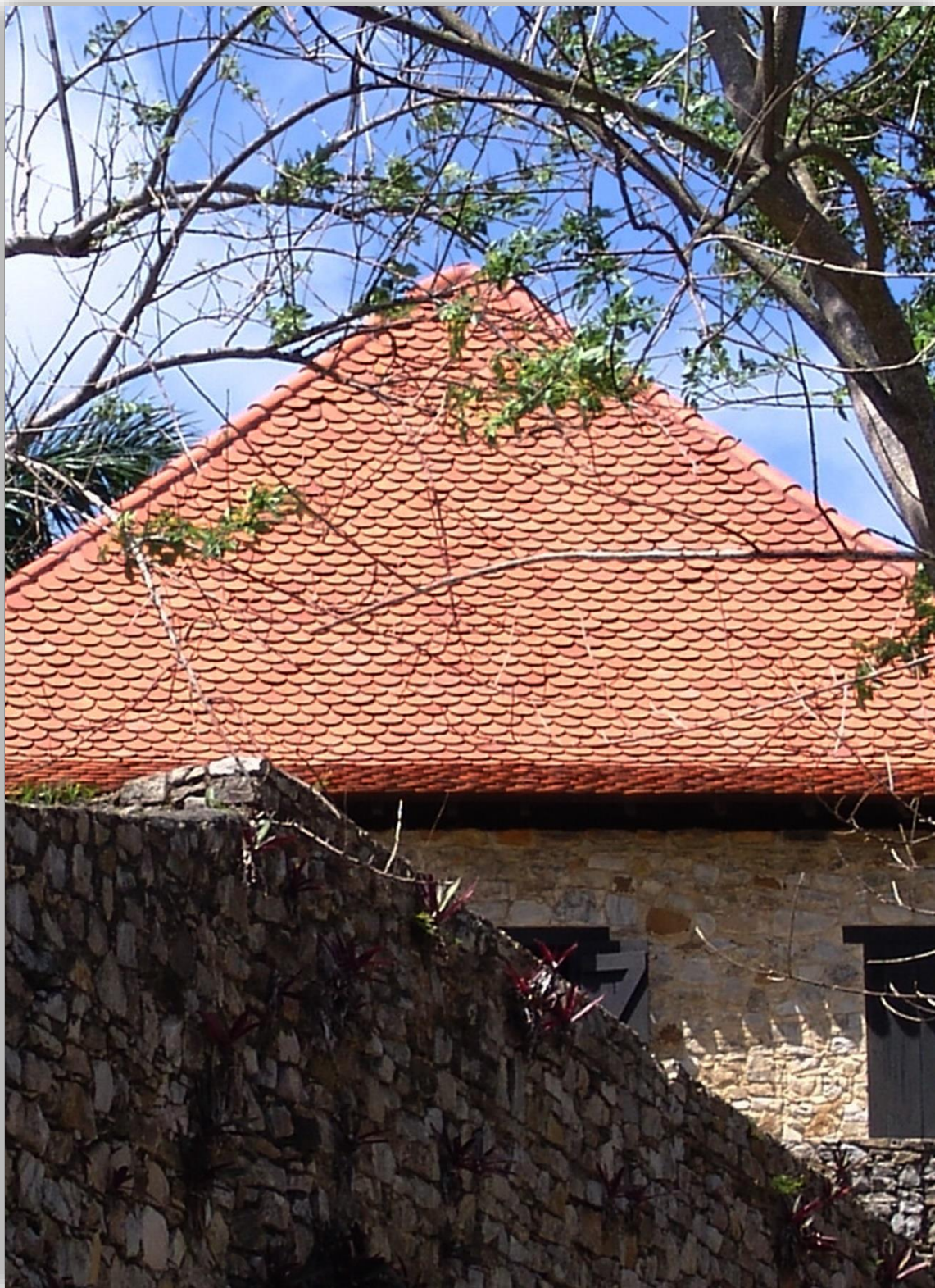
Fotografía 6.167: vista parcial de la cubierta de una casa restaurada del Cafetal Buenavista, en Sierra del Rosario (Cuba). La restauración utilizó tejas planas, atípicas respecto a otras tejas francesas empleadas por influencia de los franco-haitianos migrados a Cuba, entre 1800 y 1868. Captura del 18 de marzo de 2008.
