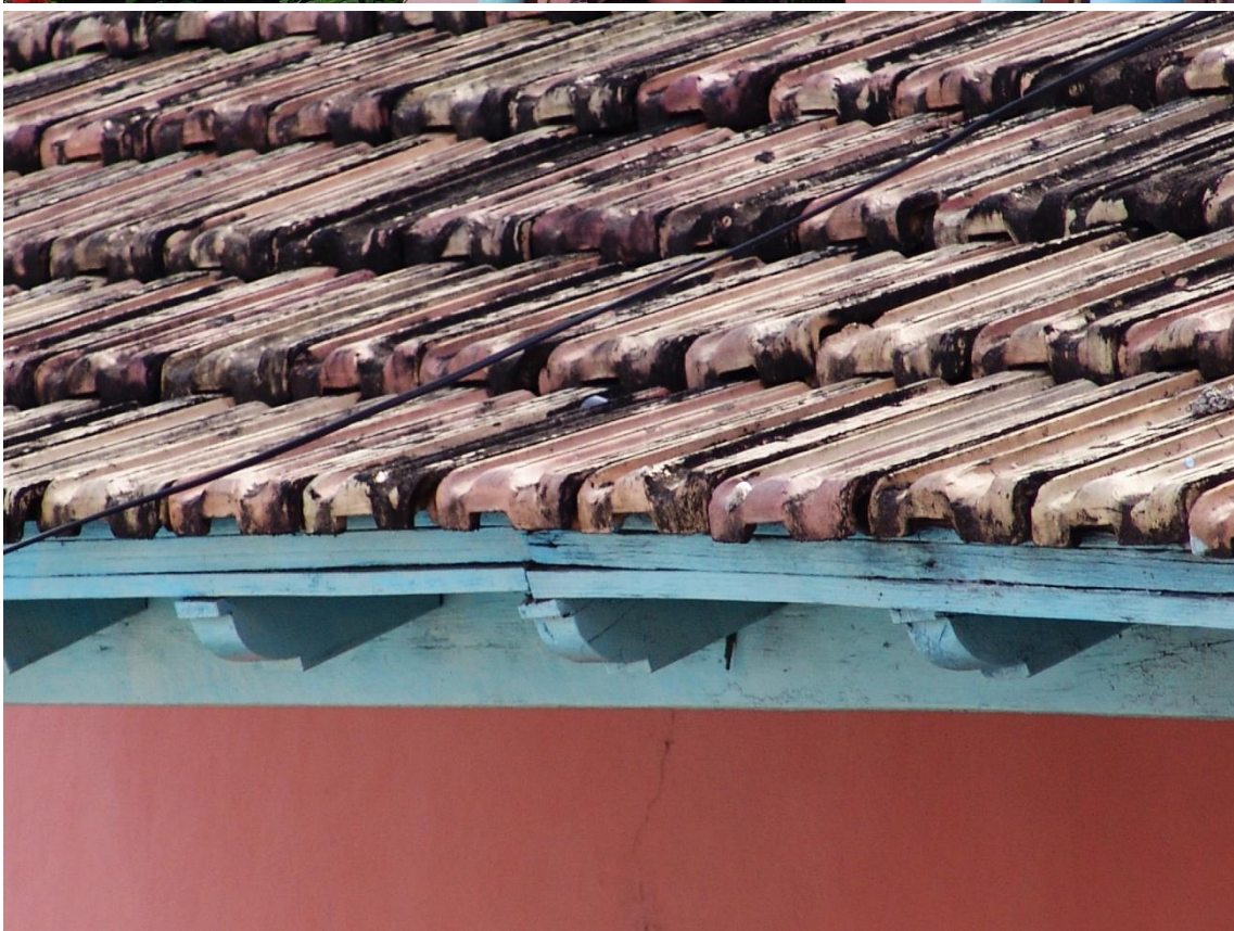
Fotografías 6.87 y 6.88: casa con un tejado de teja francesa, en las proximidades del Barrio Francés de Santiago de Cuba. Esta construcción está en vecindad con otra con un tejado con teja criolla (izquierda de la imagen superior). Capturas del 5 de julio de 2007.
