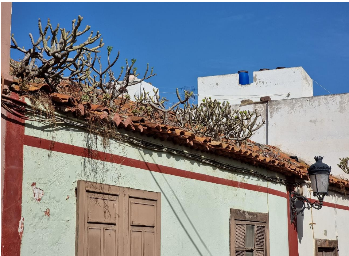
Fotografía 5.11: detalle de la colonización por jardines silvestres , en el tejado de tejas, de la casa terrera que estuvo ocupada por la antigua panadería. Calle Pérez Galdós. Casco histórico de Guía de Gran Canaria. Captura del 29 de agosto 2021.
