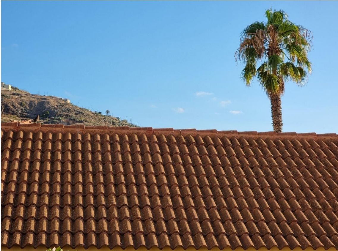
Fotografía 5.58: cubierta del Colegio Público de Educación Especial Marente, en Guía de Gran Canaria. La cubierta está formada por planchas de mortero, que imitan la morfología de un tejado, construido con tejas de arcilla, de tipología árabe (truncocónica). Captura del 3 de agosto de 2021.
