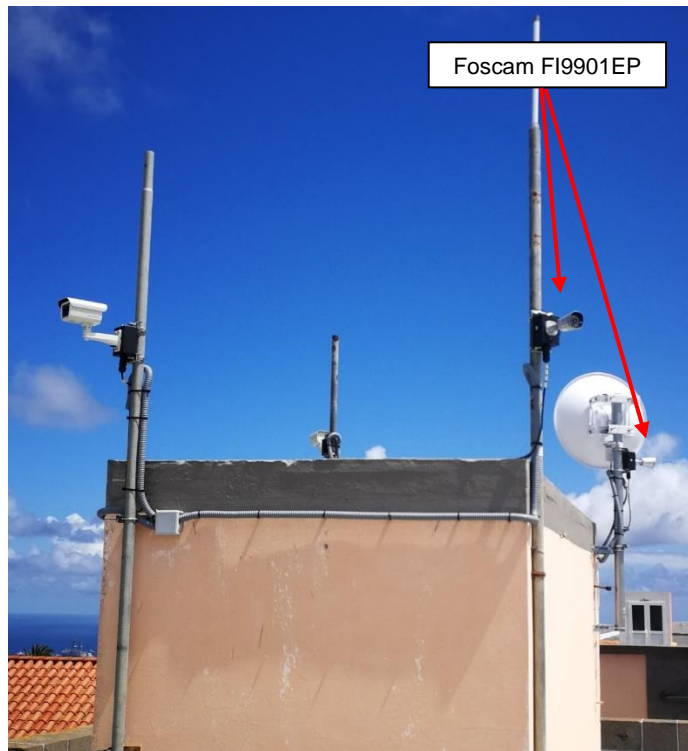
Imagen 25. Cámaras FOSCAM de la base ULPGC. Edificio de Electrónica y Telecomunicación, en la cubierta del pabellón B.
