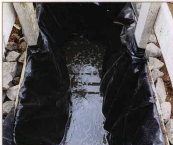
Arqueta final de depuración.
