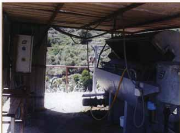
Instalación del separador (tamiz rotatorio), abierto para su autolimpieza
